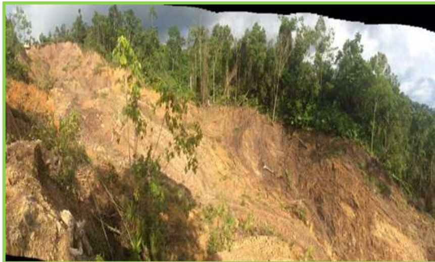
Figura 9. Remoción de derrumbes.
