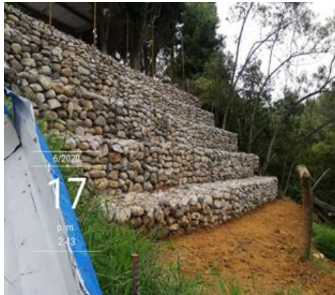
Ilustración 22 Muro de Contención, S/E García Rovira
