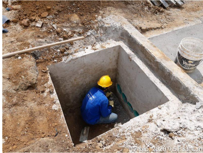
Ilustración 37 Zona para tapa en concreto S/E Principal
