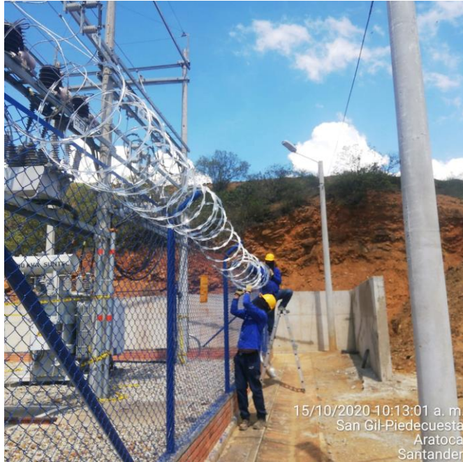
Ilustración 28 Instalación de concertina S/E Chicamocha
