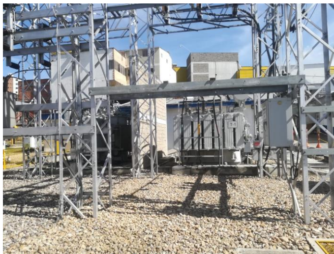
Ilustración 24 Transformadores S/E Sur
