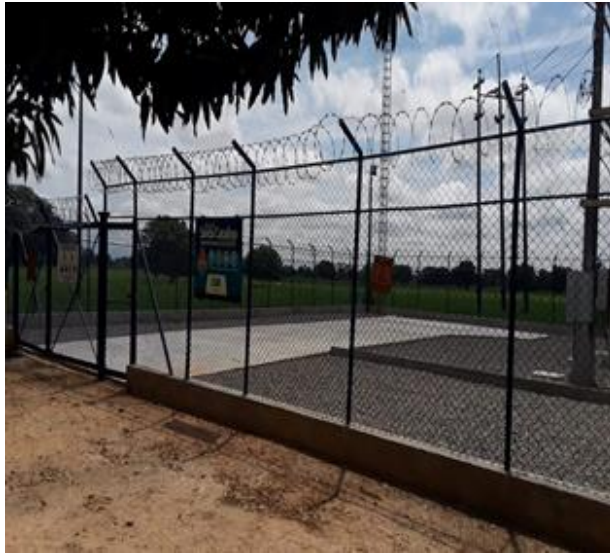
Ilustración 30 Portón S/E Santa Catalina
