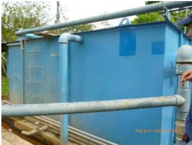
Fotografía 15.Unidad tratamiento de agua para plantación.
