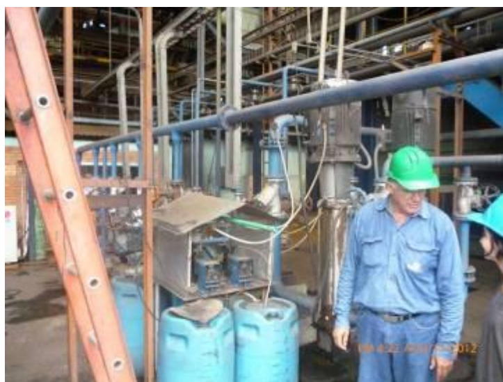
Fotografía 14. Planta tratamiento de agua para calderas.
