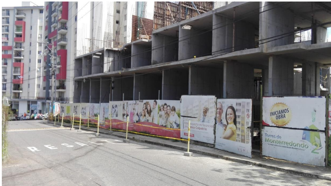
Imagen 85. Seguimiento ICA, Torres de Monterredondo-Bucaramanga.
