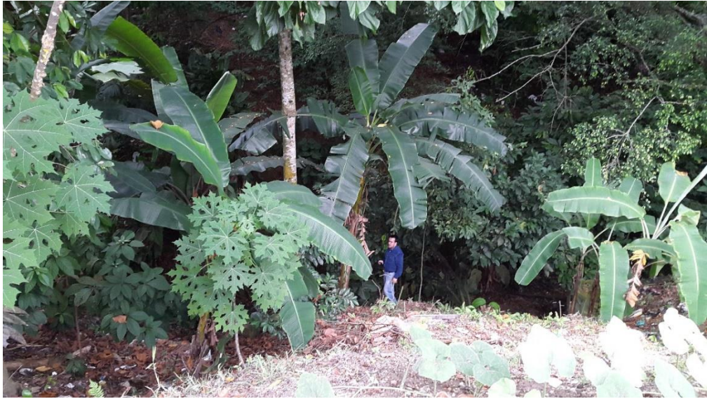
Figura 31. Taludes socavados por un colector de aguas lluvias
