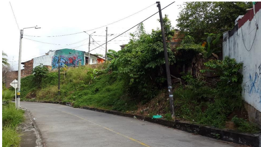
Figura 33. Talud a estabilizar en el barrio Primero de Mayo
