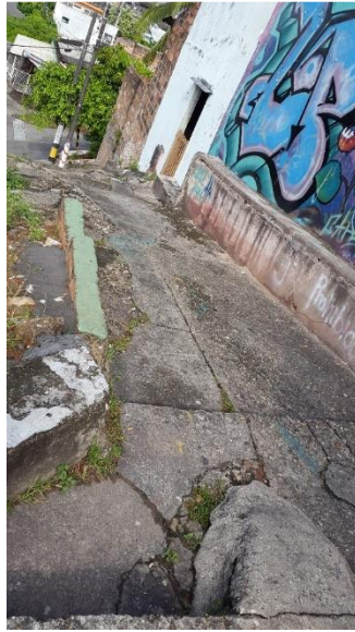
Figura 32. Escaleras a reemplazar en el Primero de Mayo
