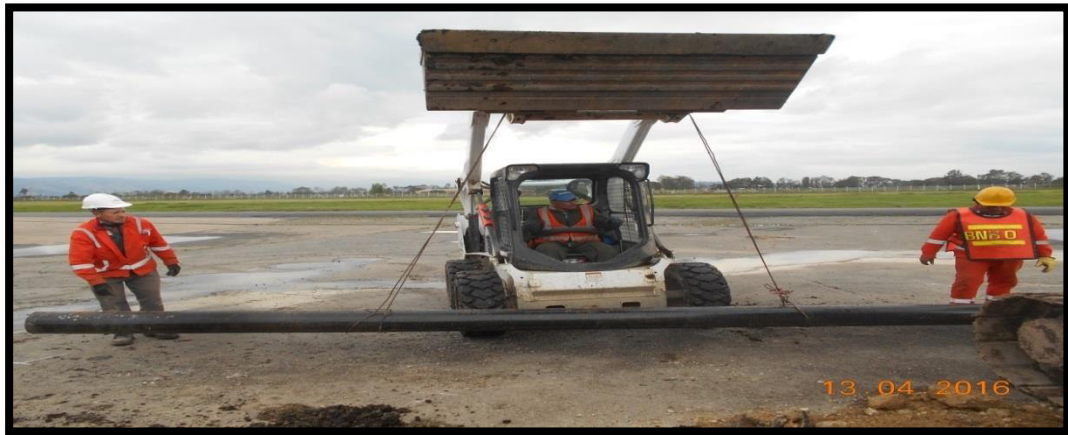
Figura 54. Instalación de tuberías en el canal que conecta caja de inspección con box culvert.
