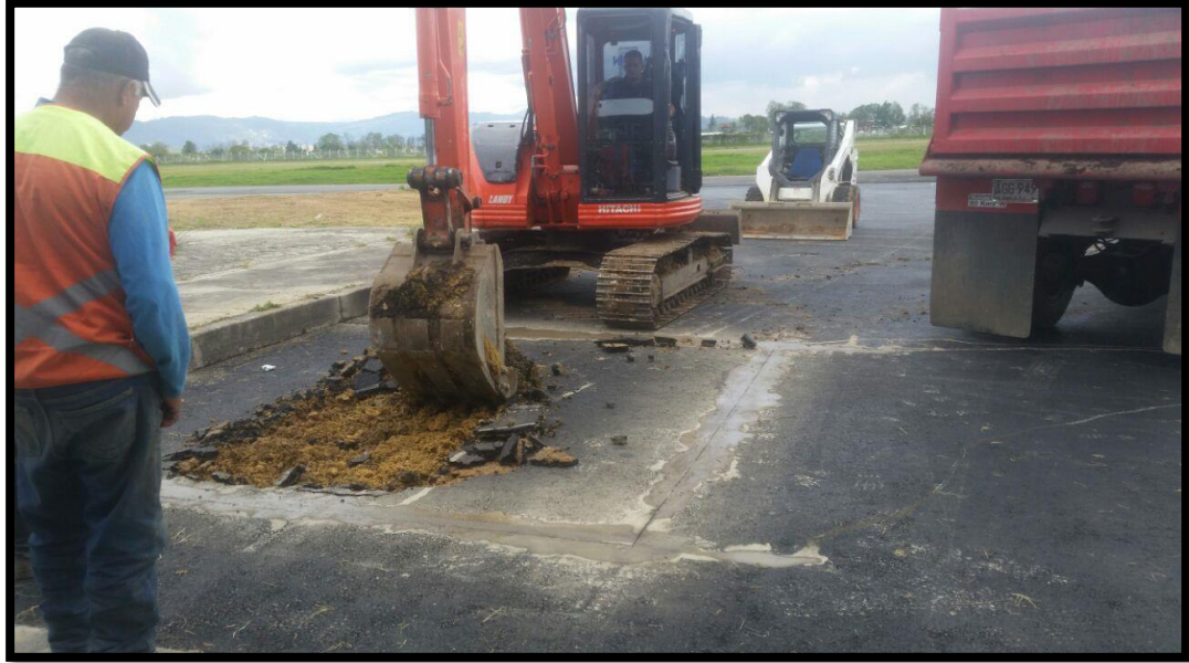
Figura. 72. Excavación de los fallos presentados.
