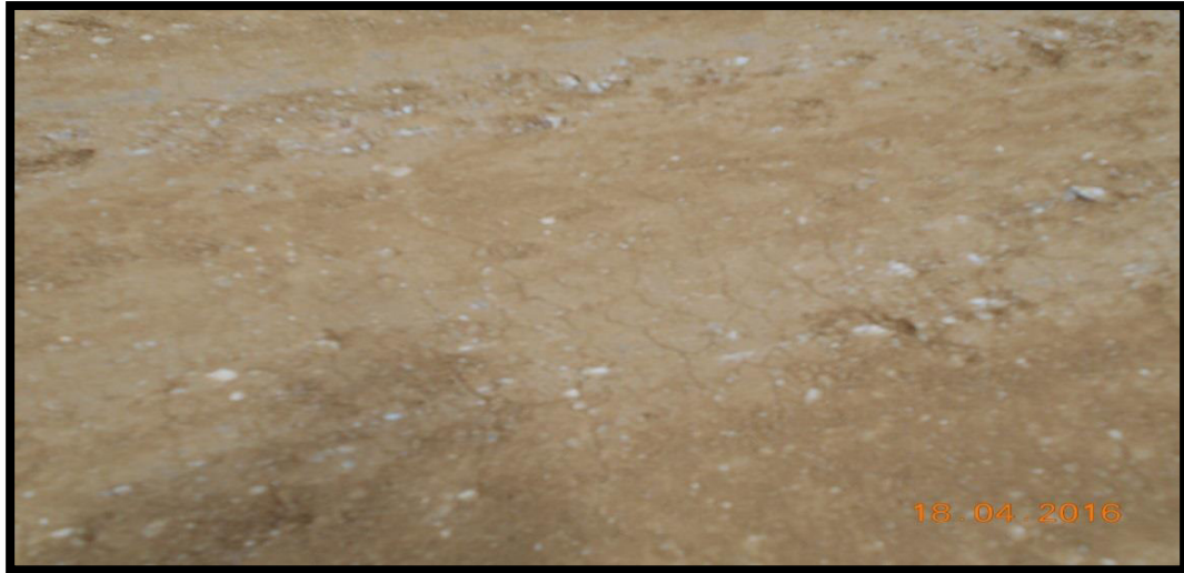
Figura 61. Fallo presentado en la base después de haberse extendido.
