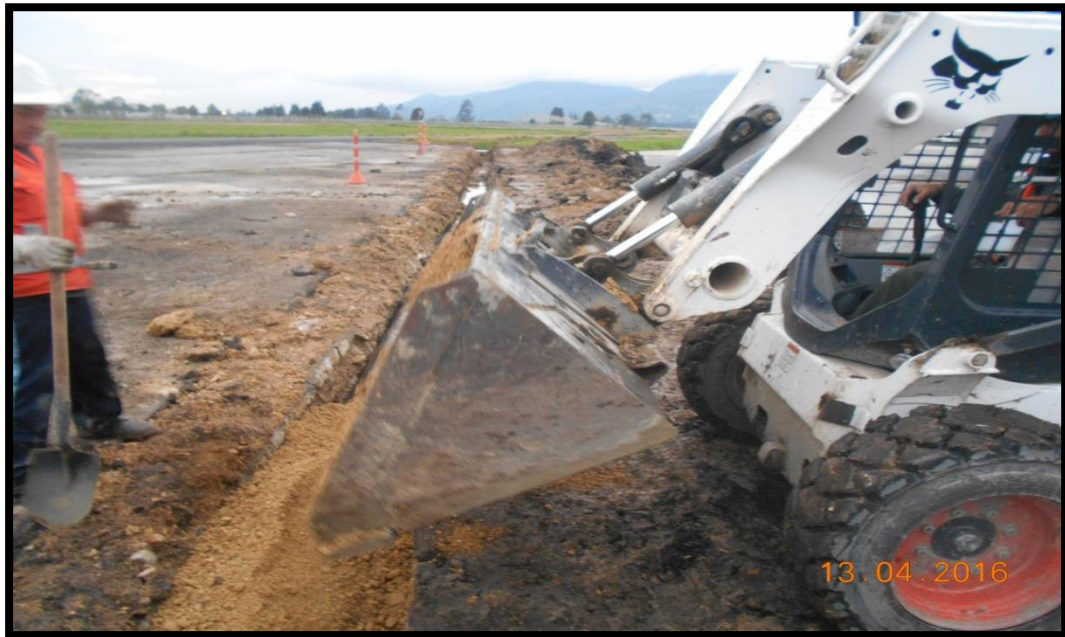
Figura 57. Relleno de material subbase a la zona de excavación para instalación de tubería.
