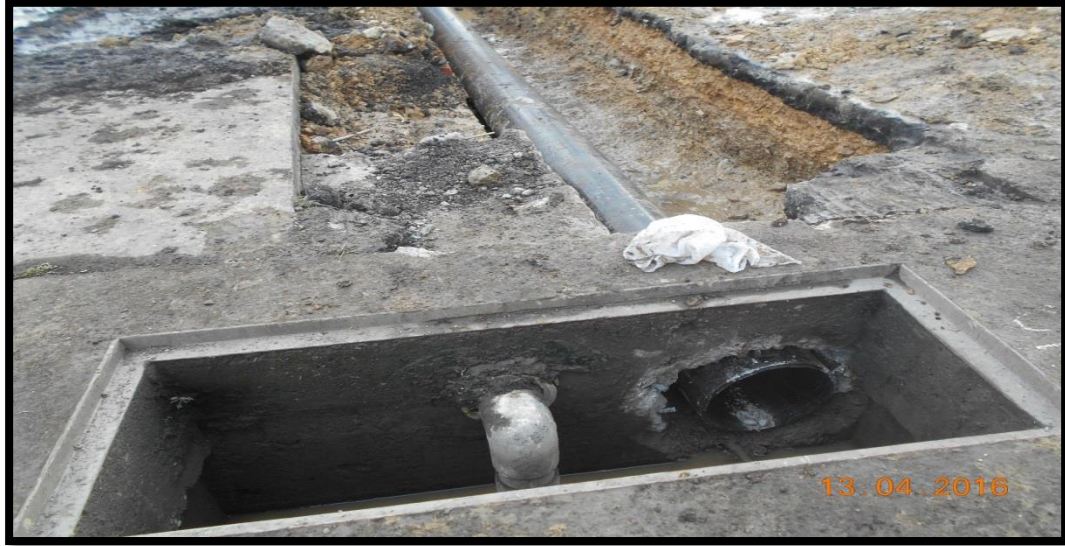
Figura 56. Caja de inspección empalmada con tubería metálica.
