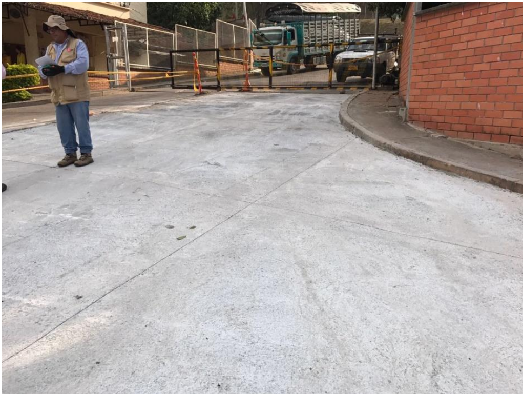
Figura 33. Vista general de la placa (FRIGORÍFICO VIJAGUAL). Fuente: Autor.
