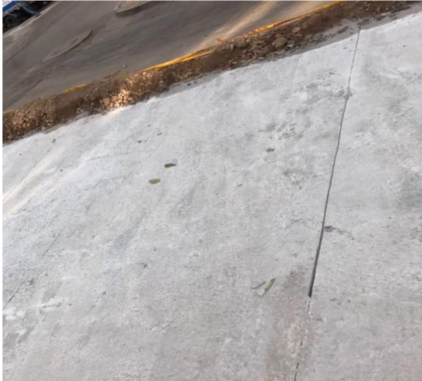
Figura 34. Fisuras presentadas en la placa (FRIGORIFICO VIJAGUAL). Fuente: Autor.
