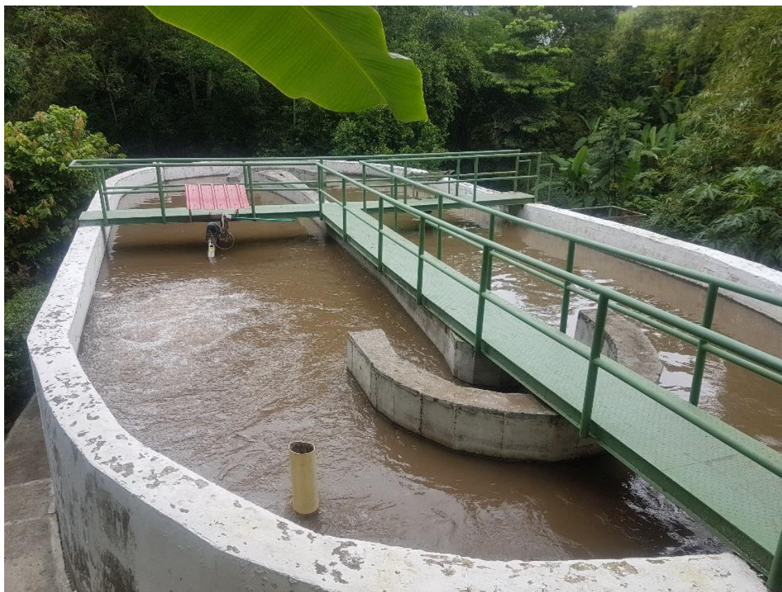
Figura 4. Fotografía de la PTAR del barrio los fundadores de Barrancabermeja-Santander Fuente: AUTOR
