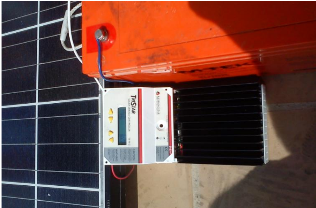
Figura 18. Controlador solar TRISTAR instalado al panel solar.
