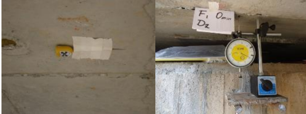
Figura 12. Instalación de deformímetros y sensores de temperatura en la parte posterior del Puente Gómez Ortiz
