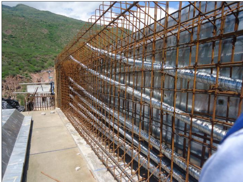
Figura 22. Ductos de la Viga Postensada Central Vano 5-6, Puente Geo Von Lengerke, Grupo IV.
