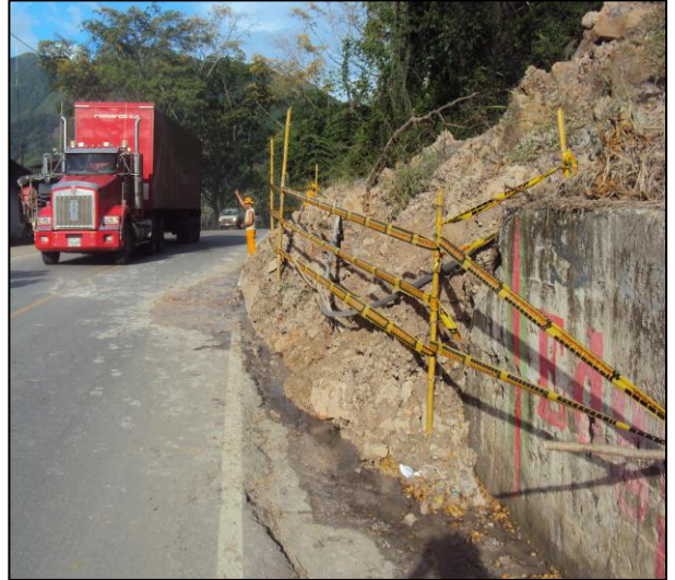
PR 14+600 Tramo 6602 Señalización de la zona de derrumbe.
