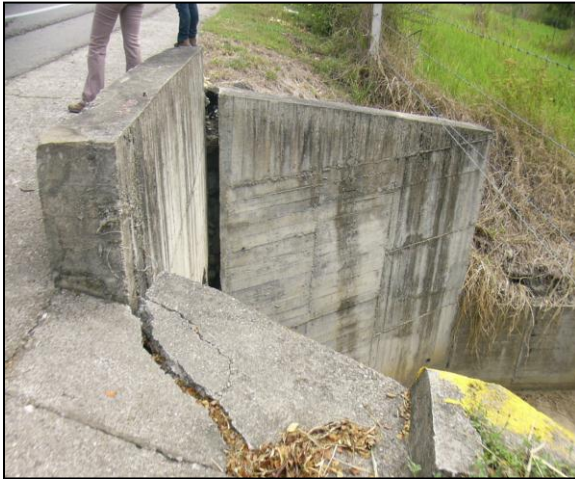
PR 27+322 Tramo 6602. Desplazamiento obra, agrietamiento en aletas.
