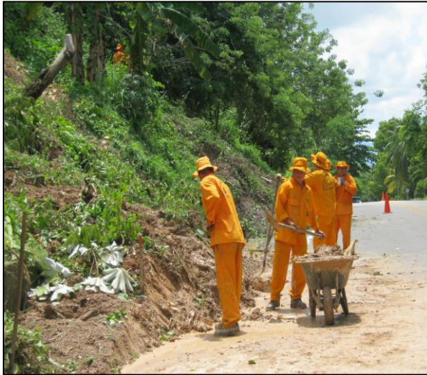
PR 48+800 Tramo 6602. Coordinación de despeje de derrumbes sobre el Corredor vial.
