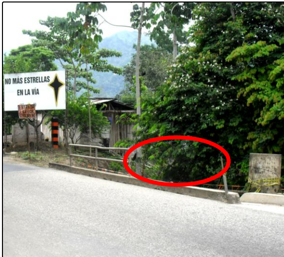
Puente Los Altos. PR 36+700 Tramo 6602. Revisión de Daños de los elementos de los Puentes.
