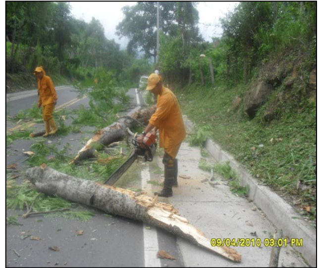
PR 38+000 Tramo 6602. Determinar la necesidad Corte y poda de Arboles que dificultan la transitabilidad delos Vehiculos.
