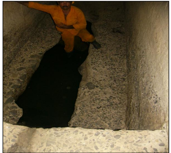
PR 35+700 Tramo 6602. Socavación de 70 cm de profundidad en Cimentación de Box-Coulvert
