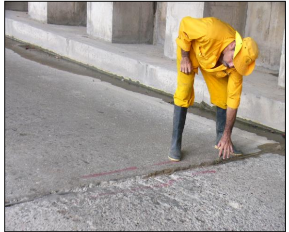
PR 20+000 Tramo 6602. Daño y abertura en las juntas del pavimento.
