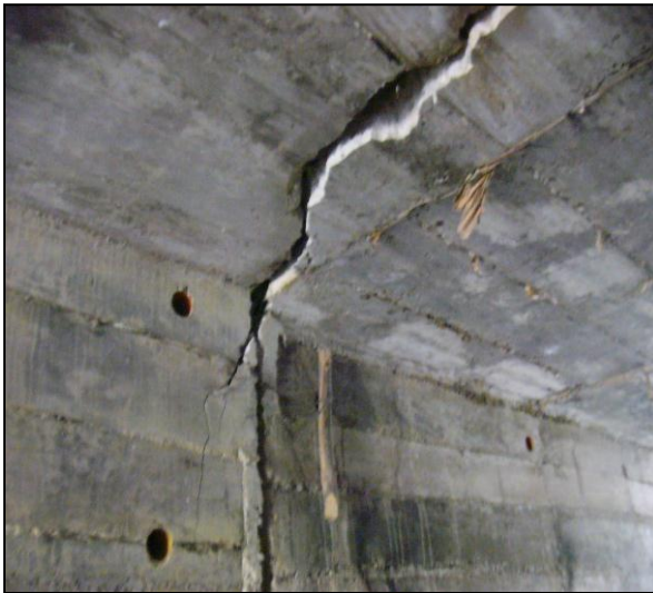
PR 29+214 Tramo 6602. Agrietamiento en la estructura de Box -Coulvert.
