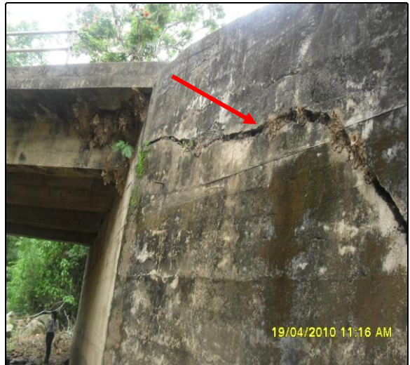
Puente Los Altos. PR 36+700 Tramo 6602. Identificación de fisuras en la estructura del Puente.
