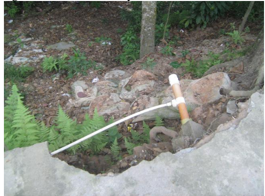
Figura 50. Altura de talud y detalle de erosión
