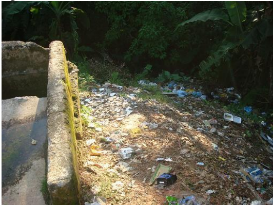
Figura 54. Presencia de basuras en talud
