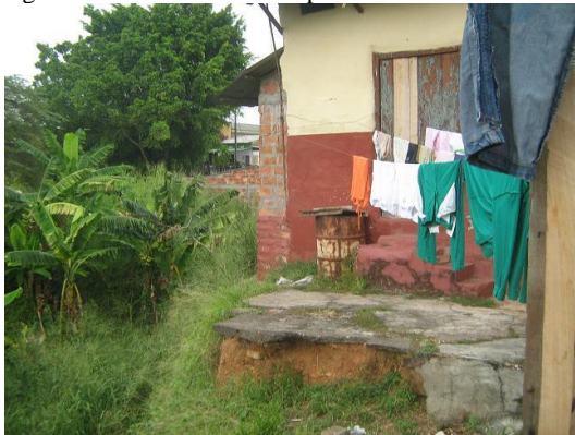
Figura 45. Erosión cercana a paredes de casas
