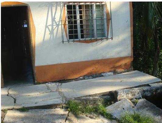
Figura 55. Agrietamientos por inestabilidad del talud
