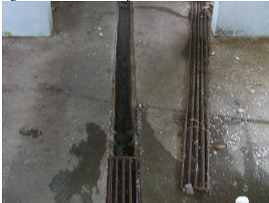
Figura 12. Deterioro de rejillas metálicas
