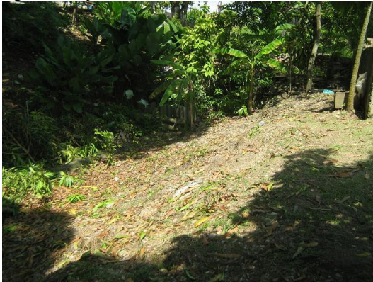
Figura 40. Apariencia de 2do talud
