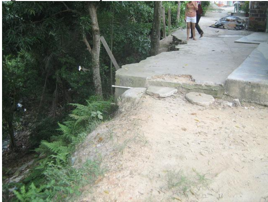
Figura 49. Caída de pisos de fachadas
