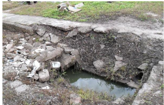
Figura 9. Deterioro de sumideros
