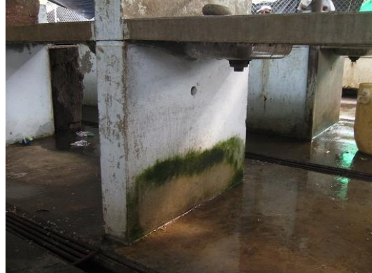
Figura 11. Deterioro de mesones y lavaplatos
