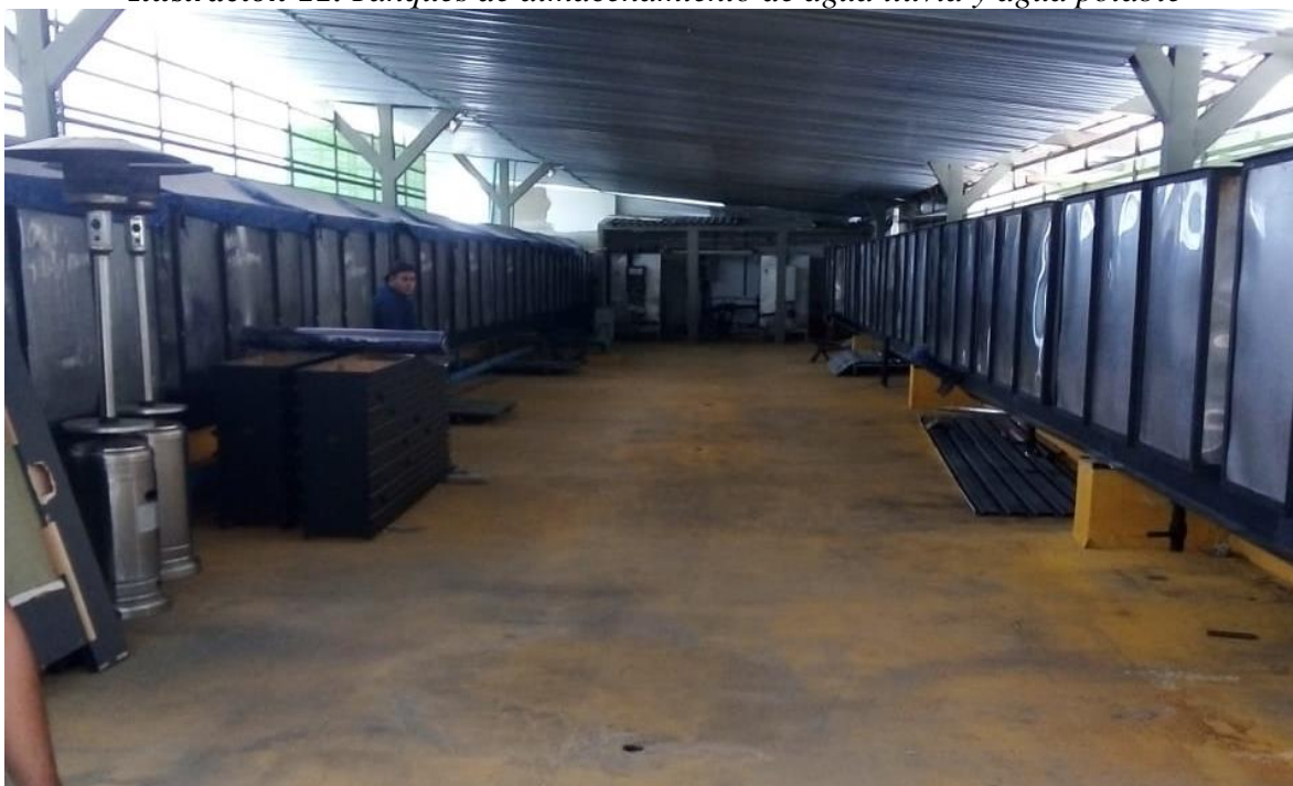
Ilustración 11. Tanques de almacenamiento de agua lluvia y agua potable
