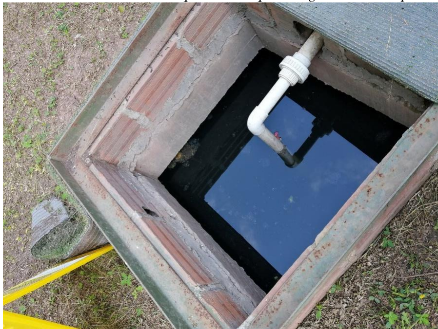
Ilustración 15. Tratamiento químico tanque de aguas lluvias captadas
