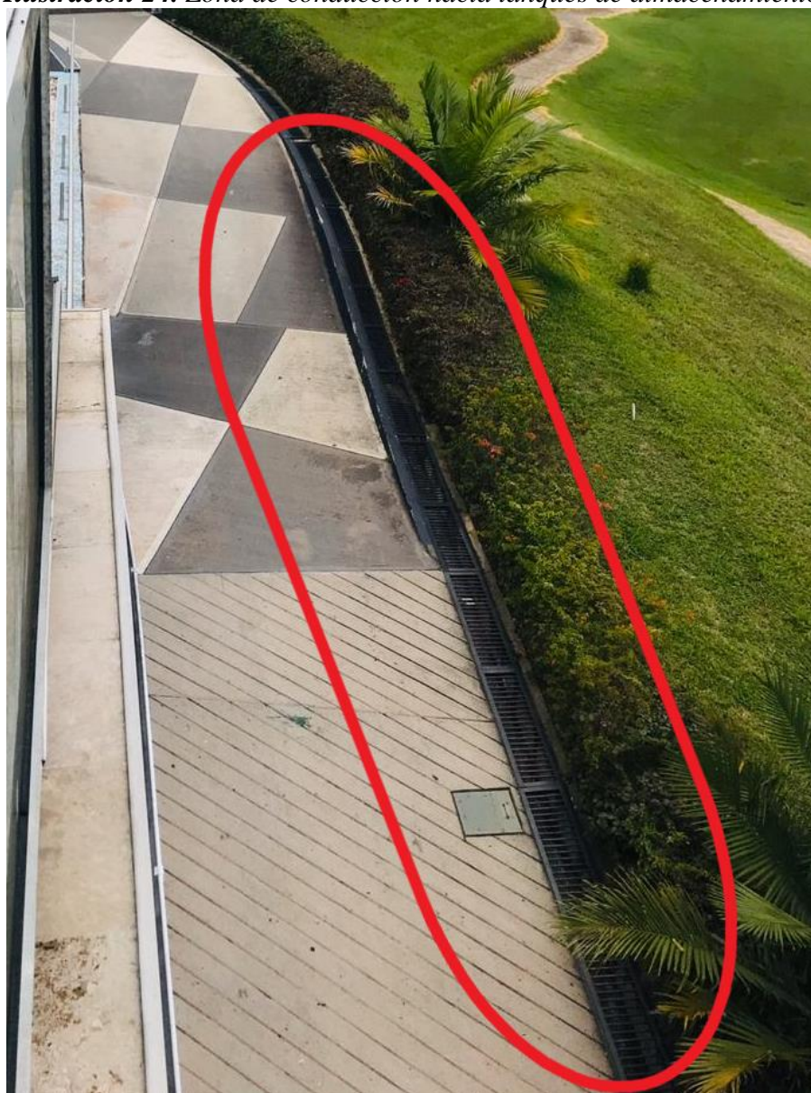
Ilustración 24. Zona de conducción hacia tanques de almacenamiento
