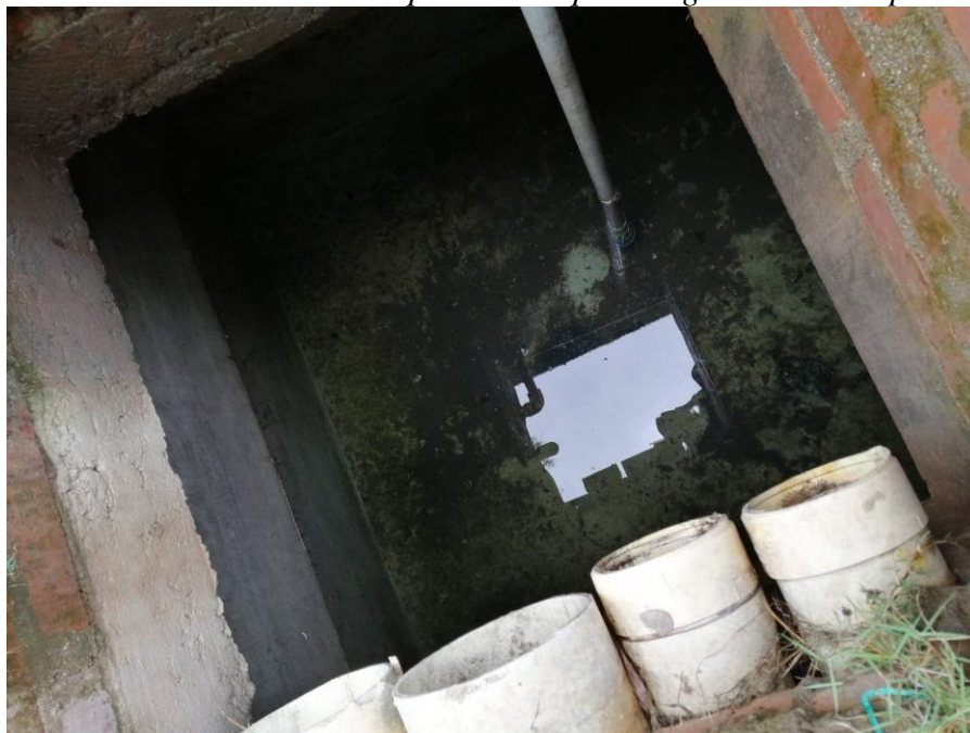
Ilustración 16. Tratamiento químico tanque de aguas lluvias captadas
