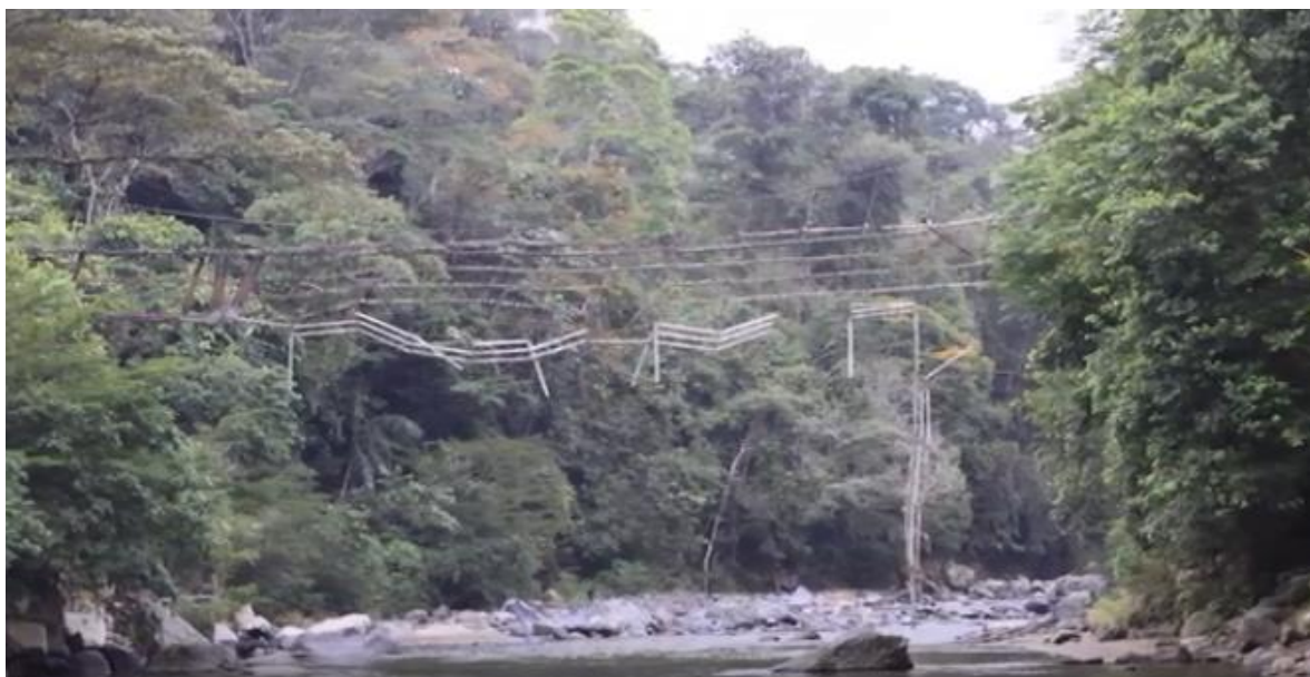
Foto 23. Puente colapsado de Puntas de Ocaidó sobre el río Arquía.
