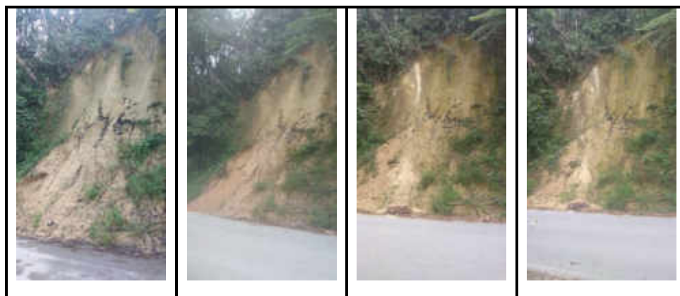
Ilustración 88. Estado de talud 1 noviembre, diciembre, enero y febrero (de izquierda a derecha respectivamente)
