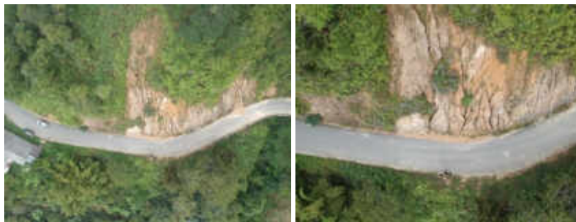
Ilustración 32. K4+900. Fotografía dron; superficies de cizalla y erosión en la parte alta del talud.
