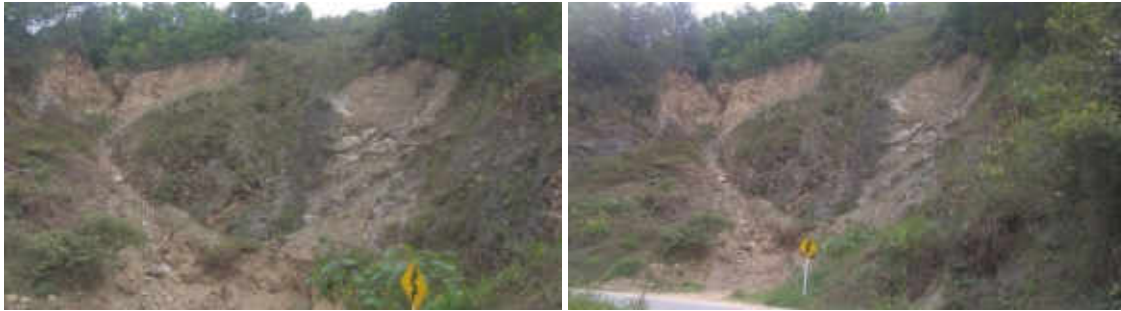
Ilustración 46. K17+700. Material acumulado sobre la superficie del talud con amenaza a caídos y zona de acumulación.
