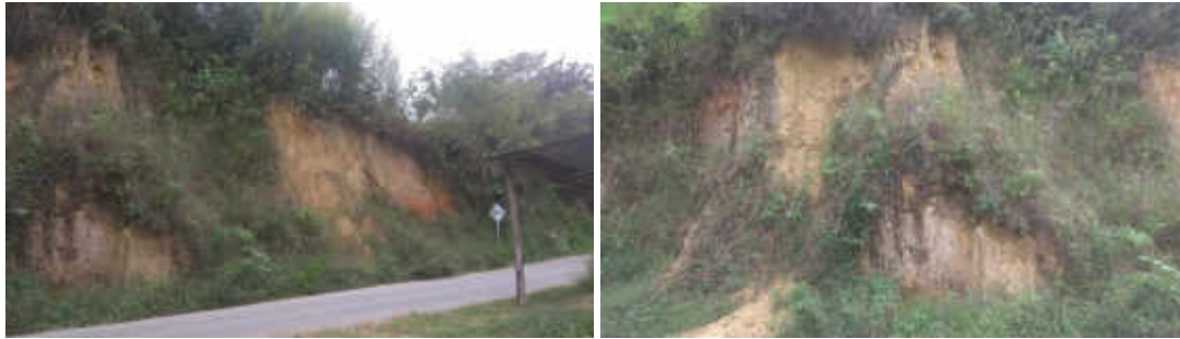
Ilustración 38. K6+000. Superficie de falla y corte de vía perpendicular.
