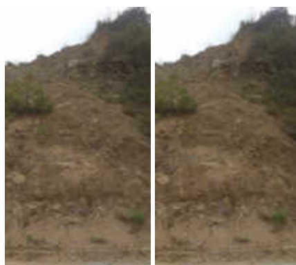
Ilustración 42. K11+400. Material acumulado sobre la superficie del talud con amenaza a movimiento y deslizamiento.
