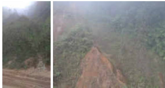
Ilustración 28. K4+200. Material de flujo parte baja del talud (Izquierda). Fotografía de dron erosión parte alta de la ladera (Derecha).
