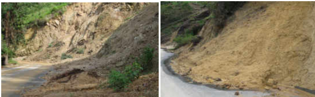
Ilustración 16. Antecedentes de deslizamiento en la vía de estudio. (Imagen suministrada Julián Galvis)
