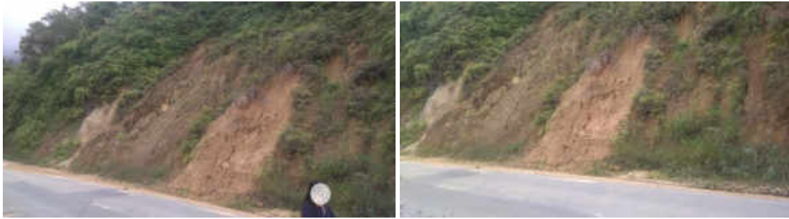
Ilustración 33. K5+000. Superficie de falla de talud ya estabilizado.
