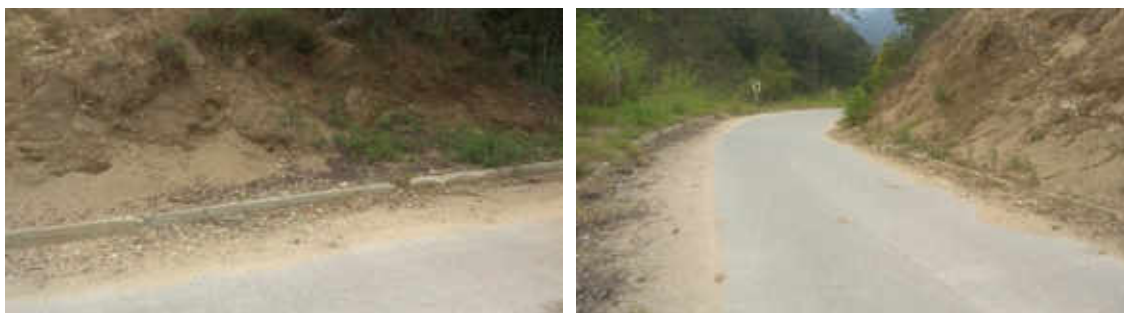
Ilustración 41. K11+400. Inicio y fin de la vía con invasiones de material.
