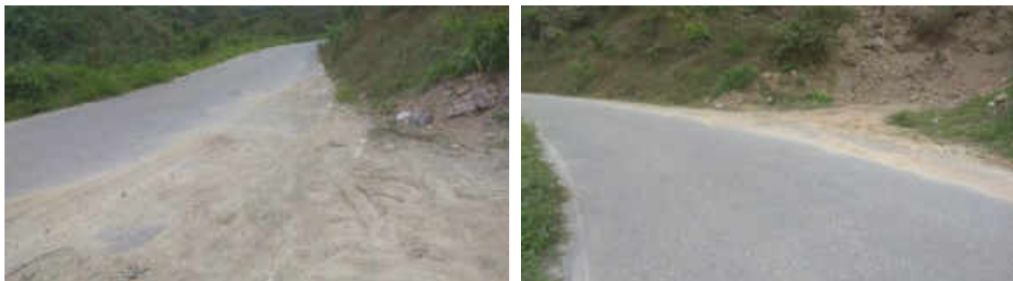
Ilustración 45. K17+700. Zona de vía con invasiones de material (Izquierda). Zona de acumulación de caídos (Derecha)
