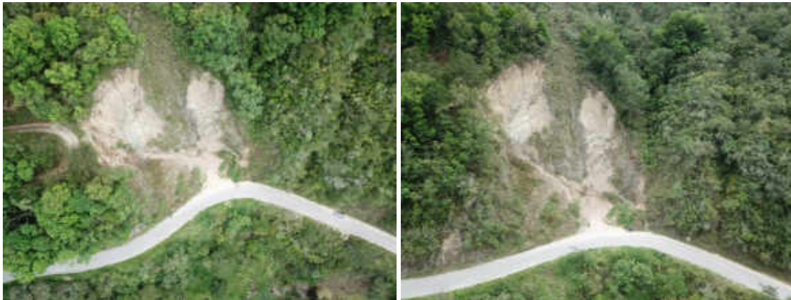
Ilustración 47. K17+700. Erosión en la parte alta y baja del talud. Superficies de falla de un deslizamiento pasado.
