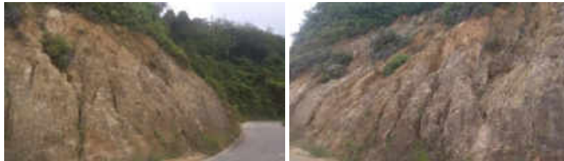
Ilustración 31. K4+900. Zona de ladera tipo estoraque con superficie en cizalla por flujo de material.
