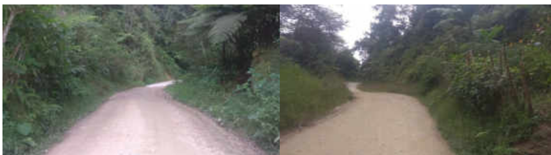
Ilustración 18. K1+200. Vía bajo el material de deslizamiento a inicio y fin. (Alta presencia de nivel freático)
