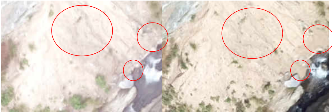
Ilustración 99. Talud 3. Perdidas de material y depósitos parte baja periodo de diciembre (izquierda) enero (derecha).
