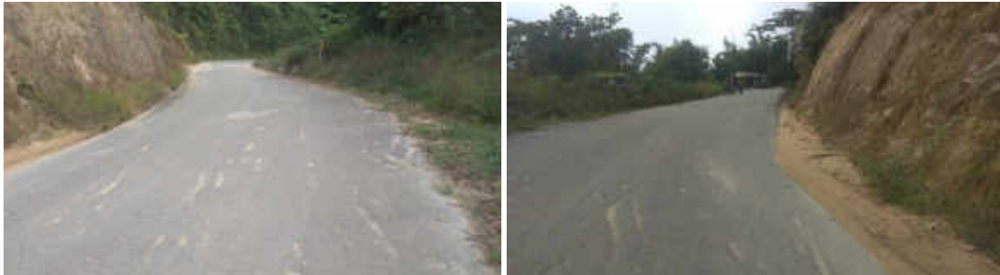
Ilustración 30. K4+900. Afectaciones a vía desde inicio a fin e invasión de material.
