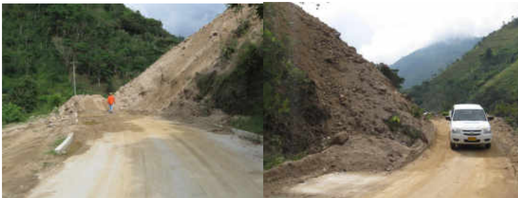
Ilustración 44. K11+400. Antecedentes a deslizamiento del año 2010. (Imagen suministrada Julián Galvis)
