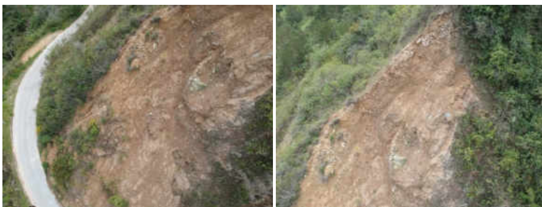
Ilustración 43. K11+400. Erosión en la parte alta y baja del talud con gran cantidad de material depositado.
