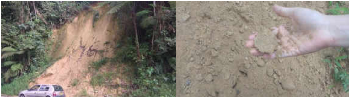
Ilustración 23. K2+600. Talud con alta pendiente, materiales arenosos y humedad elevada.
