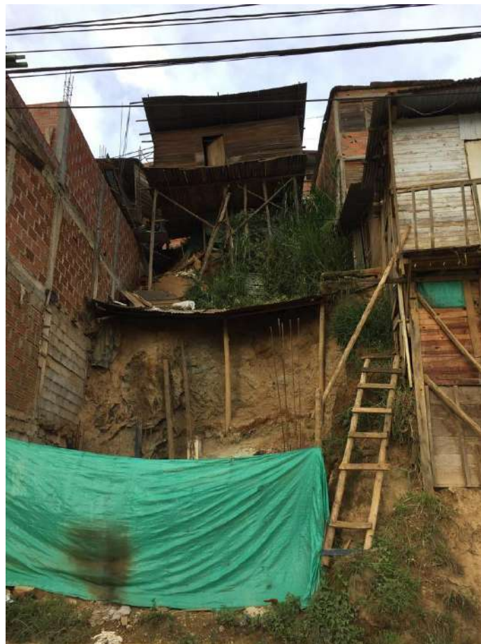
Imagen 16. Construcción en zona de riesgo no mitigable
