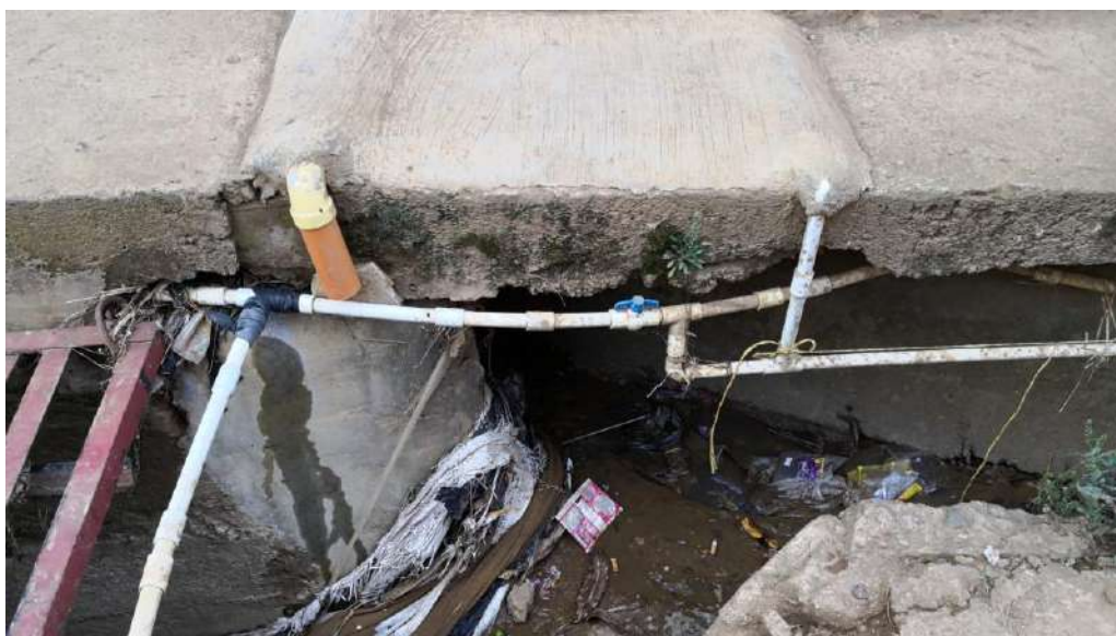
Imagen 10. Sistema de acueducto y alcantarillado comunitario
