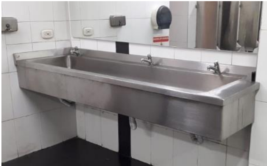
Imagen 47. Adquisición de llaves tipo push antivandálicas para el lavamanos del baño de los operarios. Fuente: La Autora.
