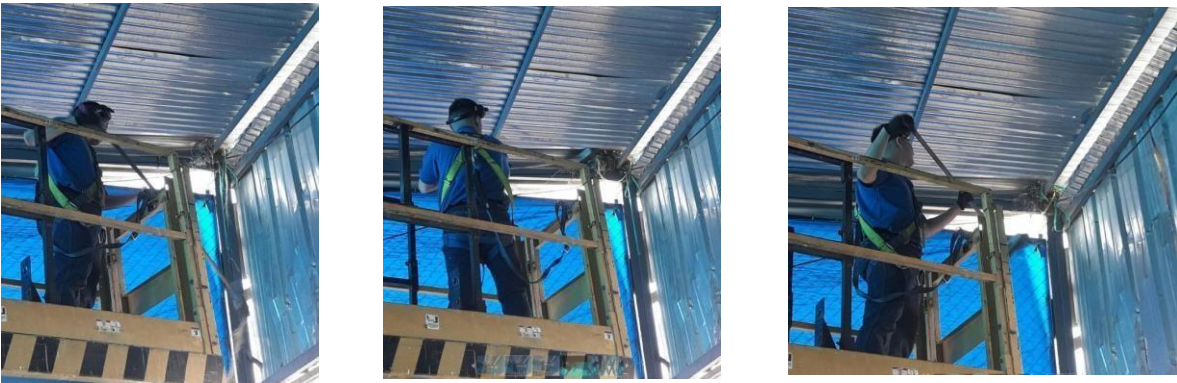
Imagen 31. Proceso de remover nidos de pájaros en el cuarto de empaque de Fibratex.
