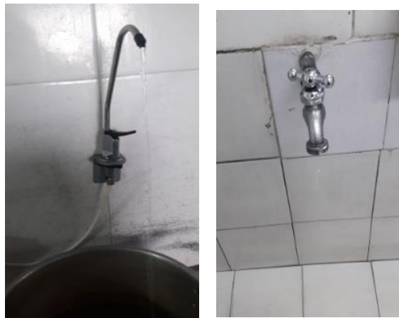
Imagen 36. Fugas de agua en el casino y en el baño de los operarios. Fuente: La Autora.
