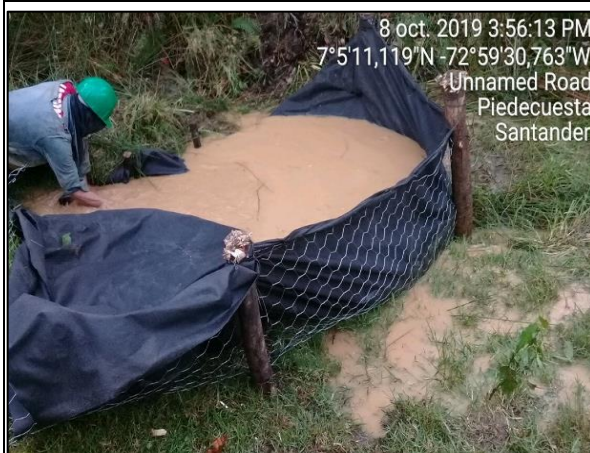
Fotografía N° 40. Puesta en marcha barras sedimentadoras Fuente: Tecnicontrol. GCHBU_PK 49+500
