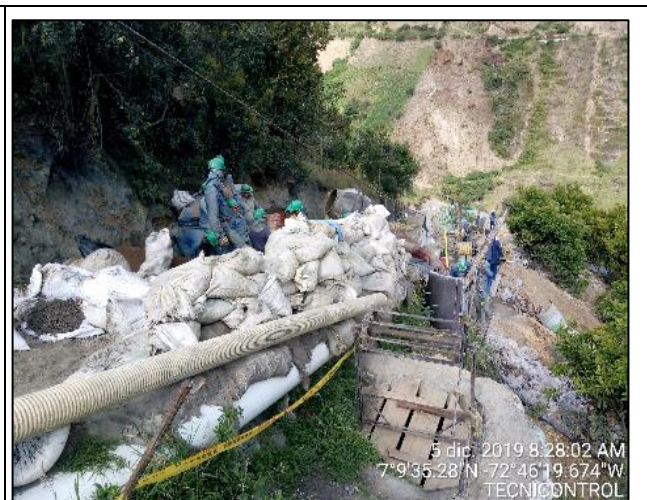
Fotografía N° 12. Fundida del núcleo de caisson en concreto ciclópeo de 3000 psi Fuente. Tecnicontrol S.A.S
