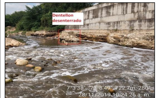
Fotografía N° 45. Dentellón socavado Fuente: Tecnicontrol
