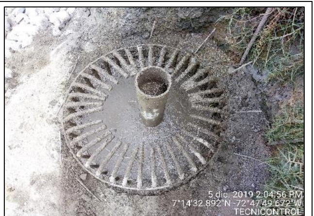
Fotografía N° 16. Fundida del núcleo de caisson en concreto ciclópeo de 3000 psi Fuente. Technicontrol S.A.S
