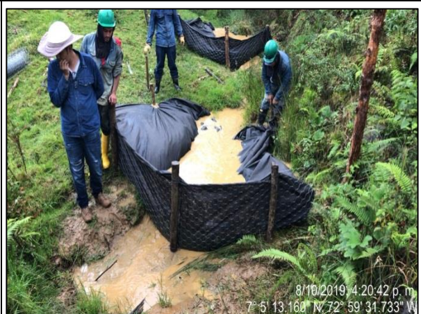
Fotografía N° 41. Puesta en marcha barras sedimentadoras Fuente: Tecnicontrol. GCHBU_PK 49+500
