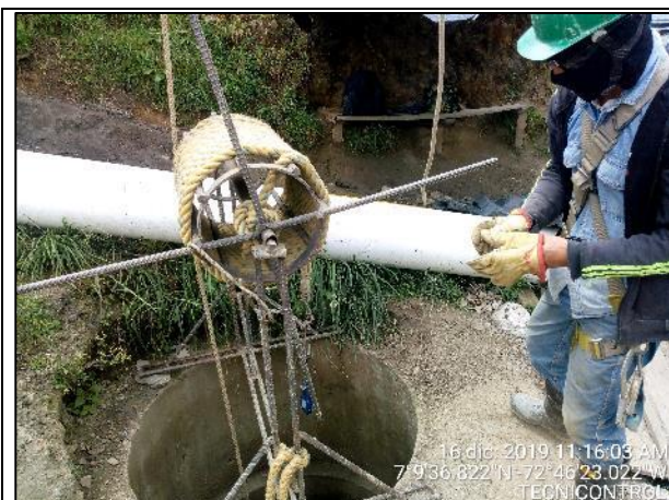
Fotografía Nº 29. Aseguramiento de trabajo en espacios confinados de los caissons, por medio de la medición de atmósferas
