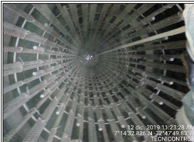
Fotografía N° 07. Verificación amarre de acero para el núcleo del caisson Fuente. Tecnicontrol S.A.S
