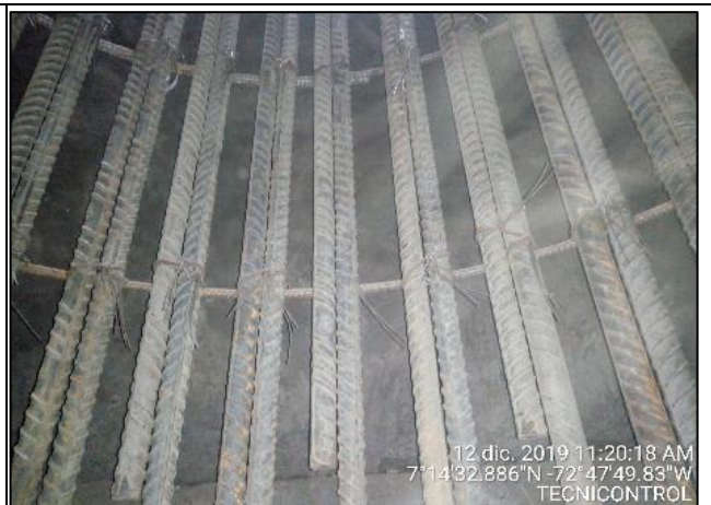
Fotografía N° 08. Verificación amarre de acero para el núcleo del caisson Fuente. Tecnicontrol S.A.S
