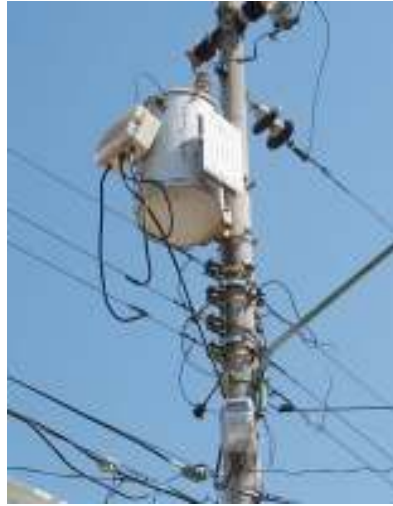
Figura 14. Vista del medidor y transformador 24
