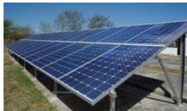
Figura 14. Paneles solares. Fuente. [27]
