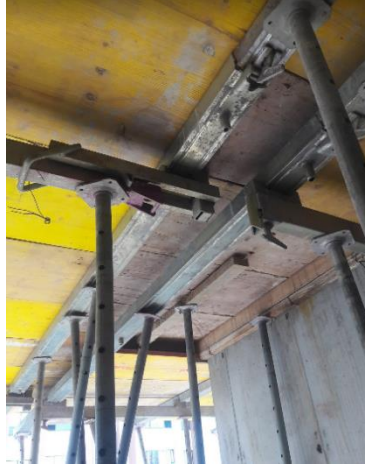
Ilustración 20 Remiendo en madera entre vanos
