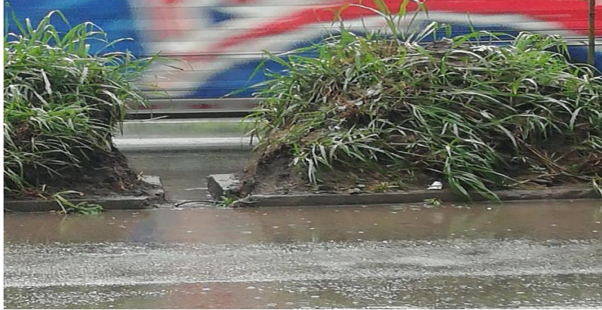
Figura 5. Punto crítico PK81+960, Fuente propia.
