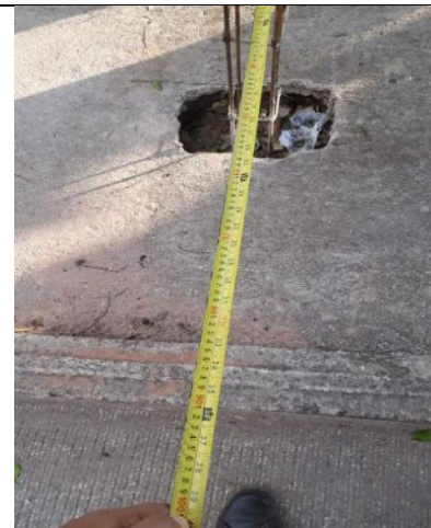
Imagen 31. Registro fotográfico para notificación suspensión de obra.
