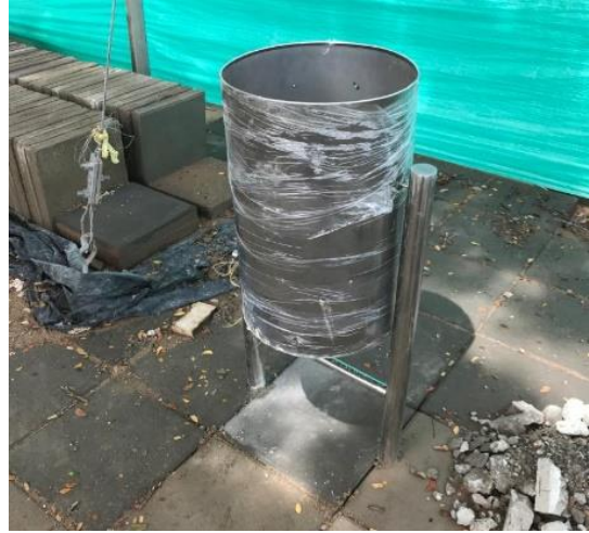
Imagen 15. Instalación caneca para basura M-121.
