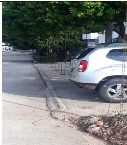
Imagen 30. Registro fotográfico para notificación suspensión de obra.
