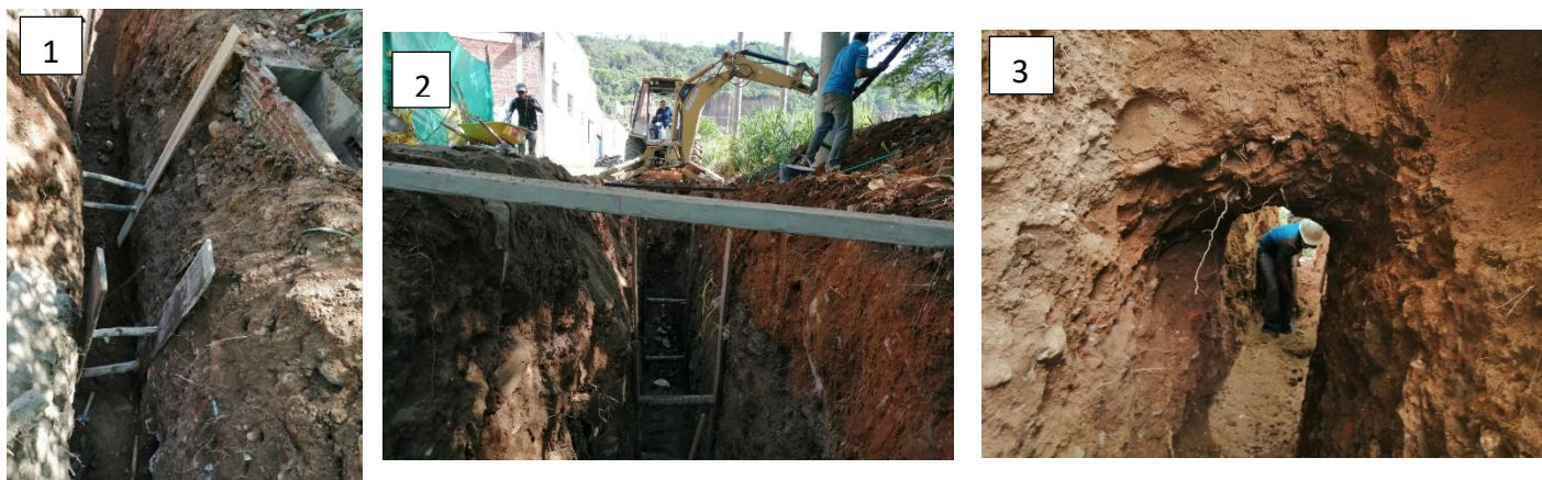
Fotografía 6 Alcantarillado pluvial Bodega Ricardo Pradilla.
