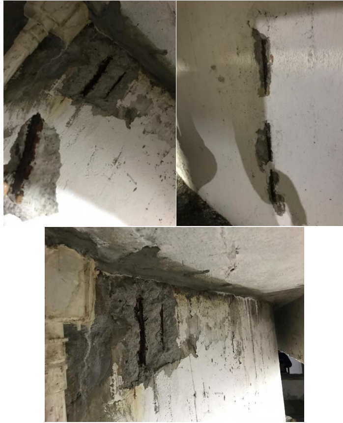
Ilustración 4. Afectación en el acero de refuerzo de la piscina del conjunto Zarzamora.
