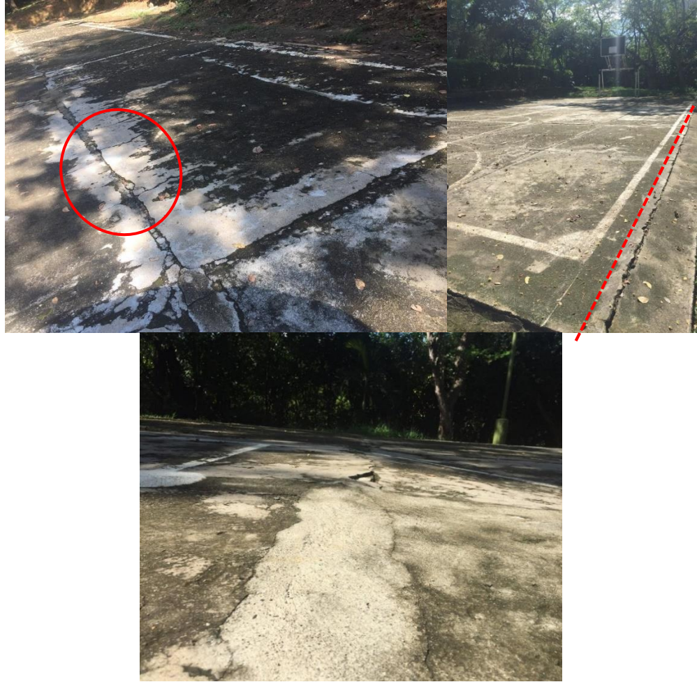
Ilustración 8. Desprendimiento entre losas de la cancha del conjunto residencial El Bosque- sector C.
