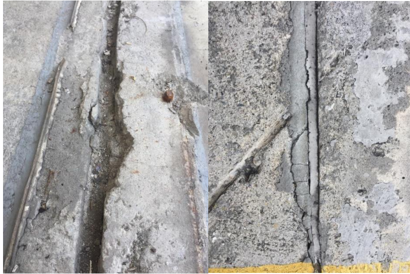
Ilustración 6.Desportillamiento de las juntas de construcción del conjunto Makadamia.
