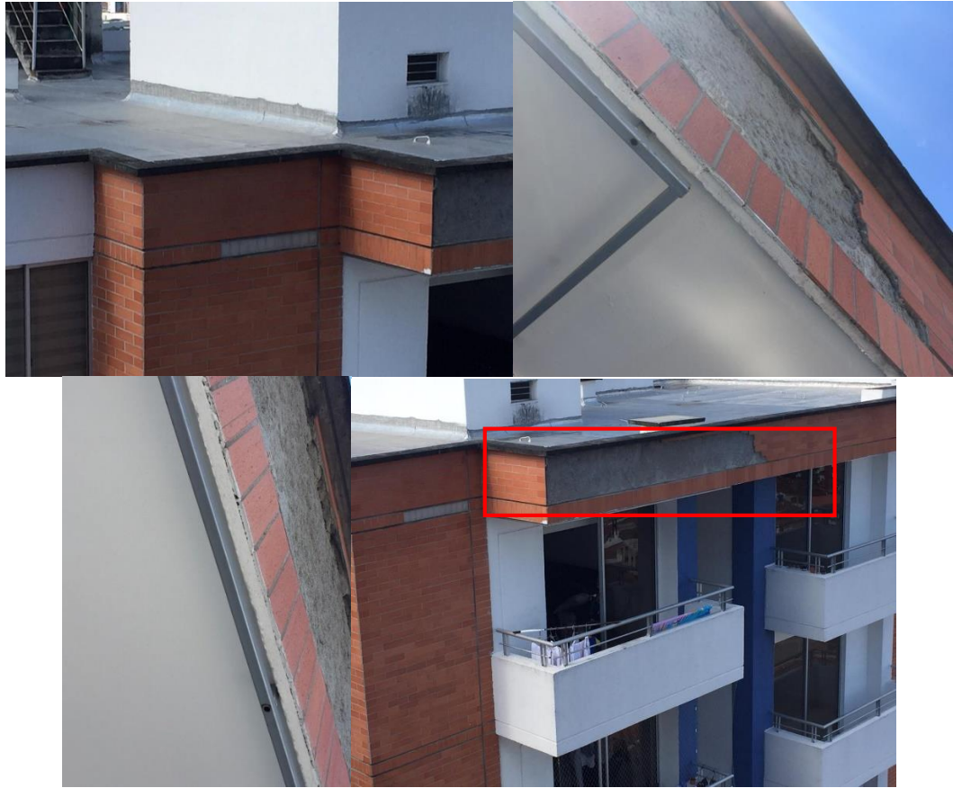
Ilustración 5. Desprendimiento de la fachaleta en el conjunto Palmas de la Frontera.
