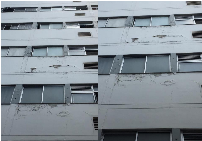
Ilustración 3. Humedad presente en las fachadas del edificio La Pequeña Italia.
