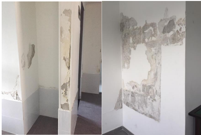
Ilustración 7.Humedad presente en las paredes exteriores del turco del conjunto Makadamia.
