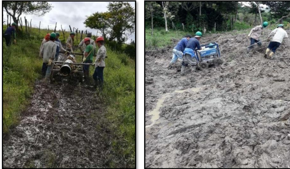
Fuente: Residente de obra, RFM & CIA LTDA
