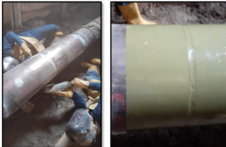
Fuente: Residente de obra, RFM & CIA LTDA
