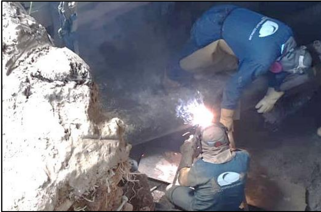
Fuente: Residente de obra, RFM & CIA LTDA
