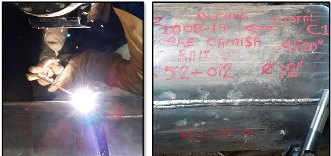
Fuente: Residente de obra, RFM & CIA LTDA
