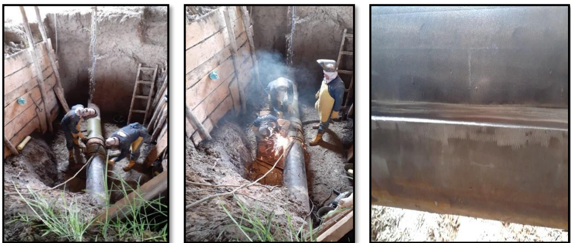
Fuente: Residente de obra, RFM & CIA LTDA
