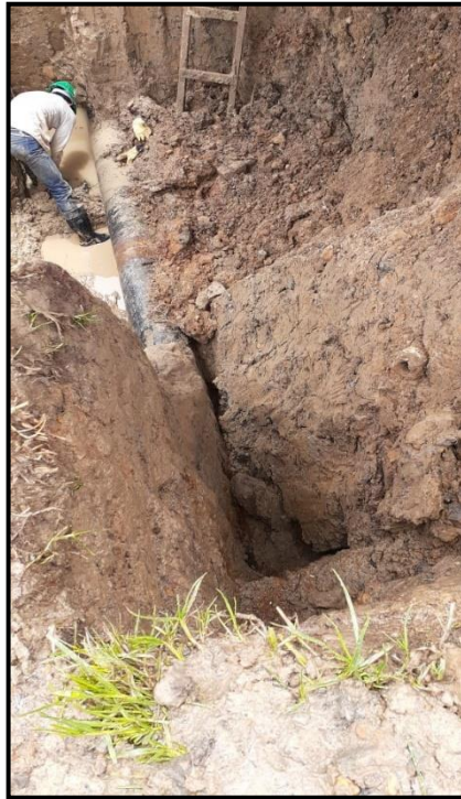
Fuente: Residente de obra, RFM & CIA LTDA
