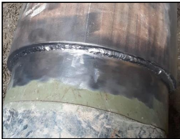
Fuente: Residente de obra, RFM & CIA LTDA
