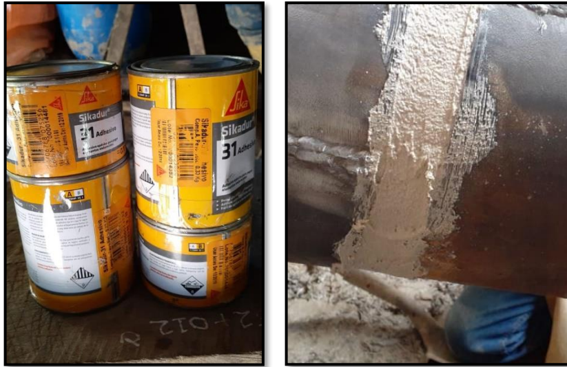
Fuente: Residente de obra, RFM & CIA LTDA
