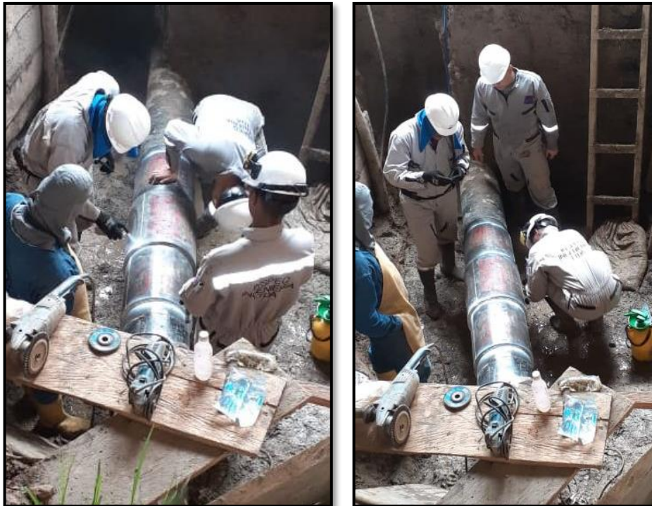
Fuente: Residente de obra, RFM & CIA LTDA
