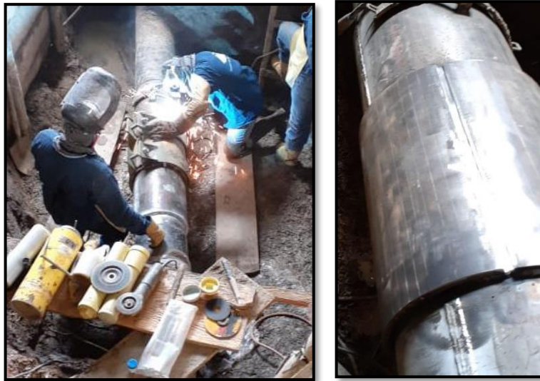
Fuente: Residente de obra, RFM & CIA LTDA
