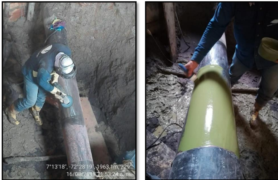
Fuente: Residente de obra, RFM & CIA LTDA
