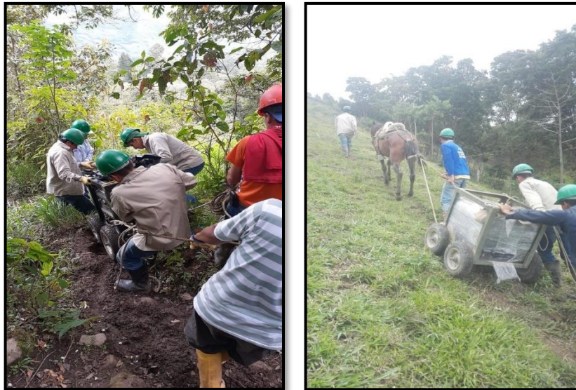
Fuente: Residente de obra, RFM & CIA LTDA
