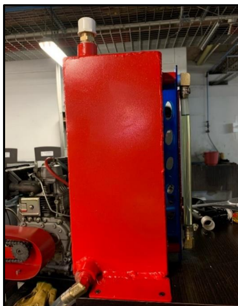
Fig.13. Tanque abastecimiento de combustible vista lateral
