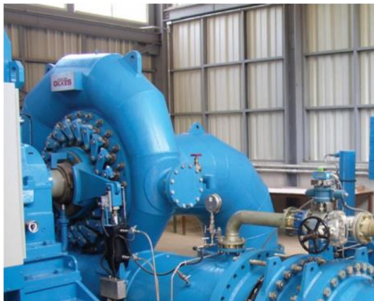
Gráfica 0.2. Turbina instalada en La Candelaria, Guatemala.
