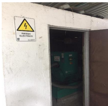
Figura 32 Señalización de riesgo eléctrico
