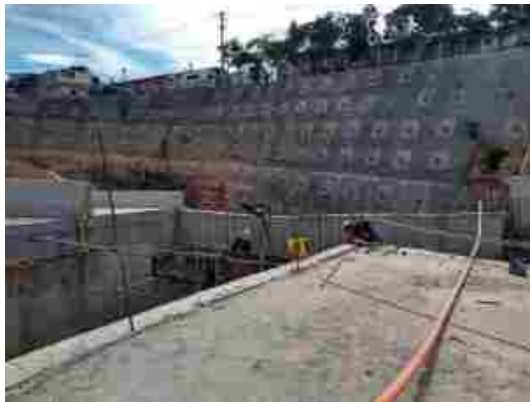
Ilustración 48. , desconfinamiento y terminación, Muros de contención costado oriental (entre puente norte, box recto y box curvo)
