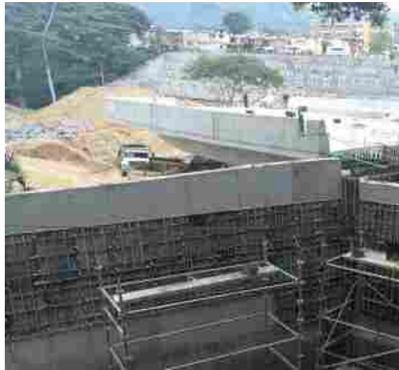
Ilustración 53. , desconfinamiento muros noroccidental (muro no anclado)
