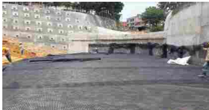
Ilustración 70. Instalación de geomalla tipo Bx-50, (relleno entre puente norte y box curvo)
