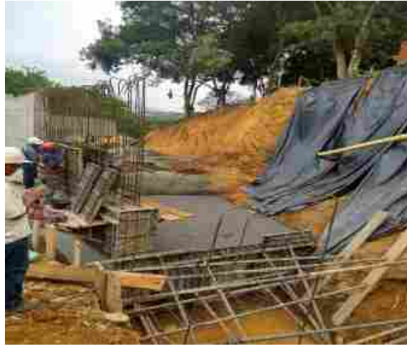
Ilustración 52. enconframiento muros noroccidental (muro no anclado)
