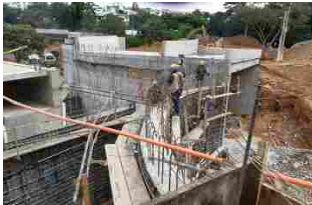
Ilustración 46. fundición y enconframiento de Muros de contención costado oriental (entre puente norte, box recto y box curvo)
