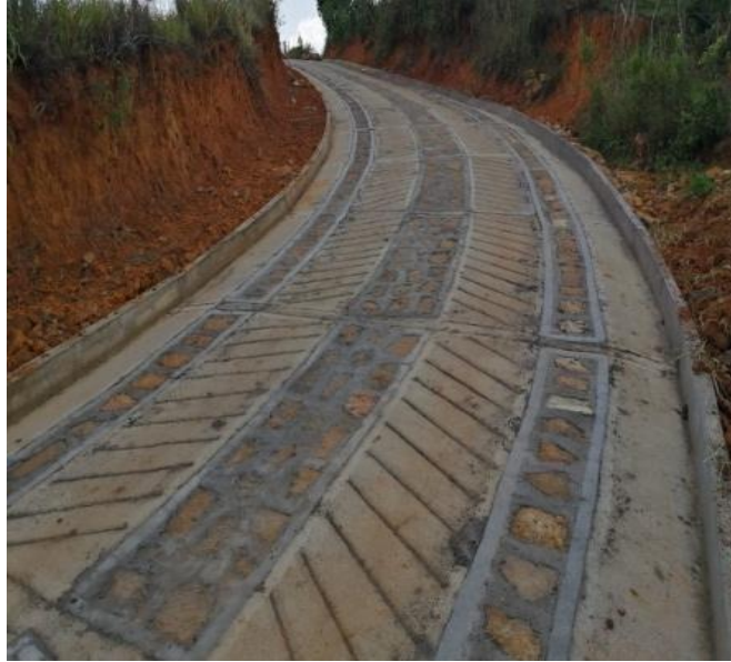
Figura 24. Revisión Placa Huella. Fuente: Autor.
