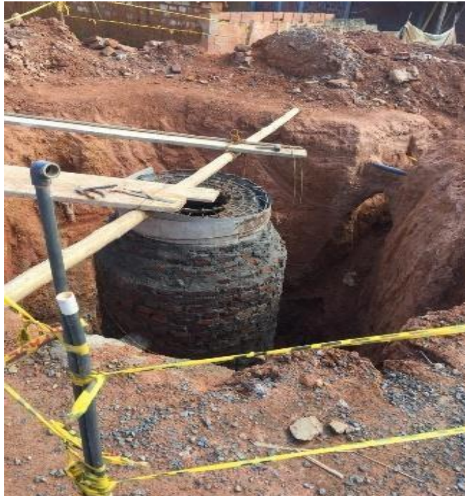
Figura 20. Construcción de pozos sépticos en la carrera 16 con calle 14 del municipio de Villanueva. Fuente: Autor.
