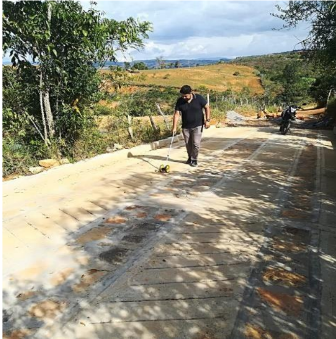
Figura 22. Revisión Placa Huella. Fuente: Autor.
