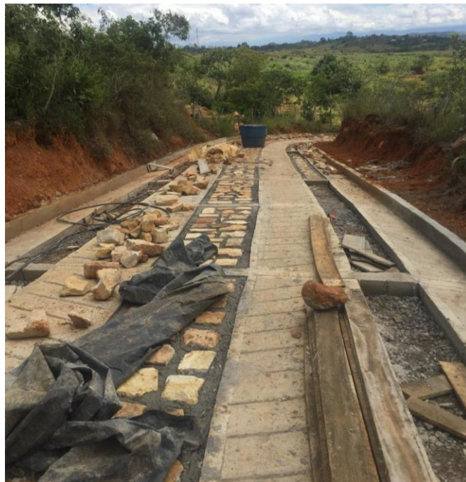
Figura 25. Revisión Placa Huella. Fuente: Autor.
