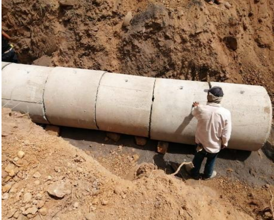
Figura 17. Trabajo de supervisión de instalación de tubería de alcantarillado rural. Fuente: Autor.
