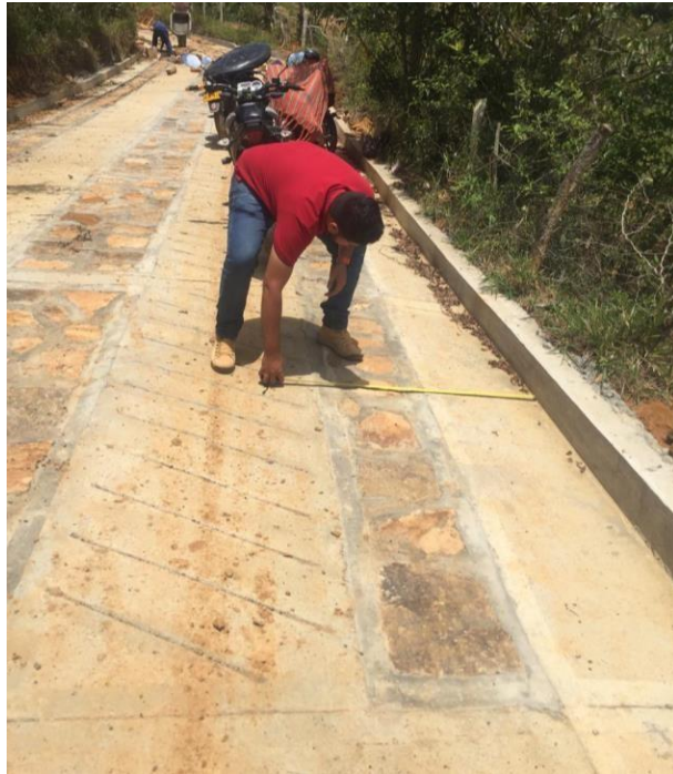
Figura 26. Revisión Placa Huella. Fuente: Autor.
