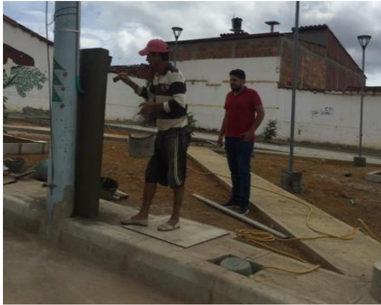
Figura 6. Trabajo de supervisión del proyecto parque recreativo y saludable - Barrio El Prado. Fuente: Autor.
