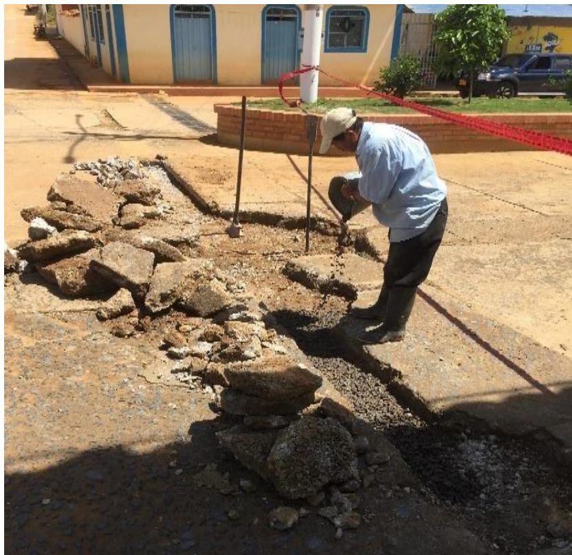
Figura 2. Visita de supervisión de repavimentación de tubería de gas - Barrio Colegio. Fuente: Autor.
