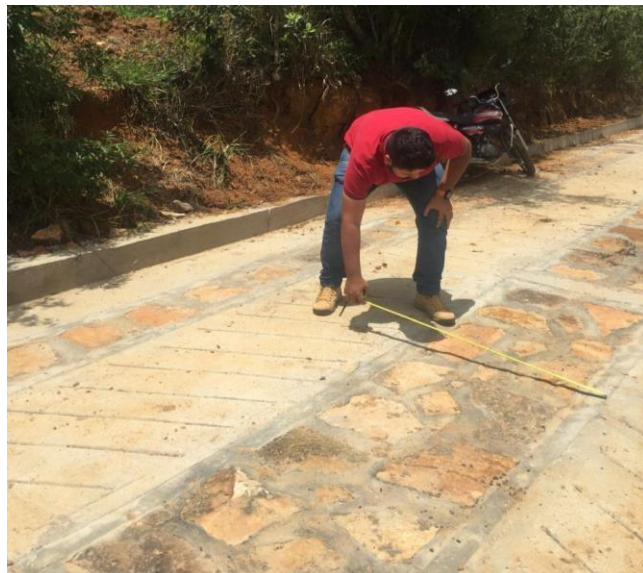
Figura 27. Revisión Placa Huella. Fuente: Autor.
