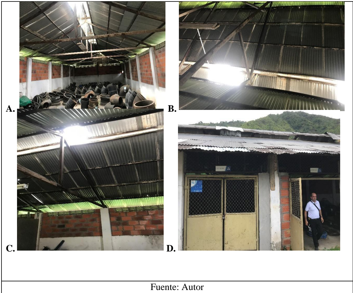
Figura 23. Techo y estructura en madera bodegas antes de la obra
