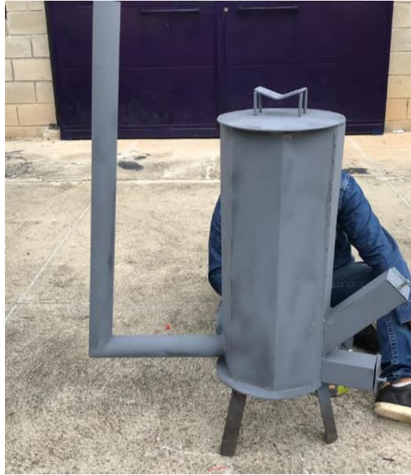
Figura 29. Aplicación de laca térmica al quemador.
