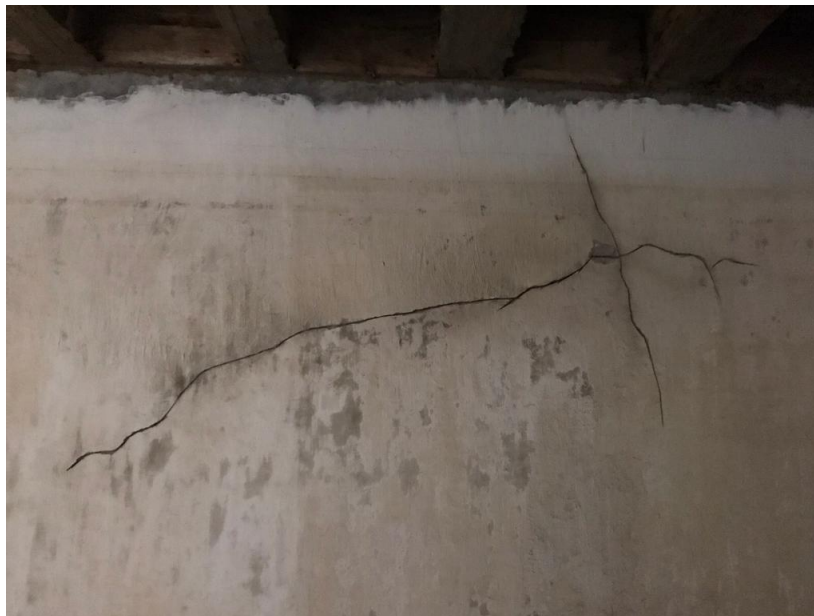
Figura 19. Fisura o grieta presente en muro de tanque de almacenamiento de agua potable.
