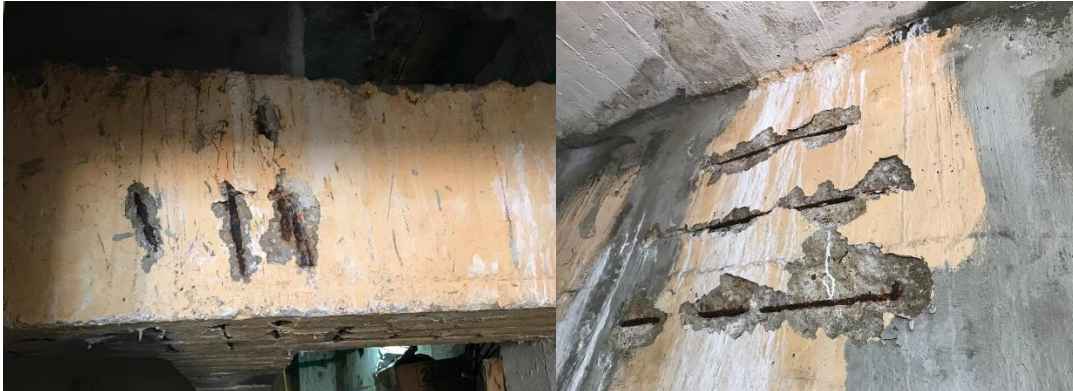
Figura 22. a) Pérdida del concreto de recubrimiento en la sección de una viga a causa de la corrosión en el acero de refuerzo. b) Desprendimiento en la parte externa del vaso de una piscina a causa de la herrumbre presente en la armadura de la estructura.
