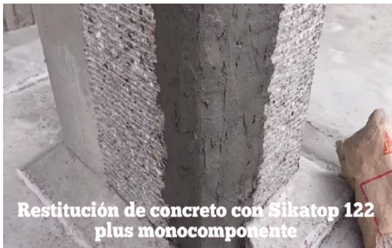
Figura 24. Reparación del concreto de una sección mediante el uso de un mortero acrílico.
