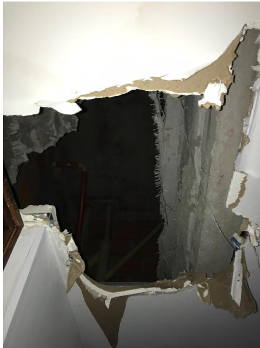
Figura 3. Pérdida parcial de cielo raso por filtración en Edificio Torre Girardot.
