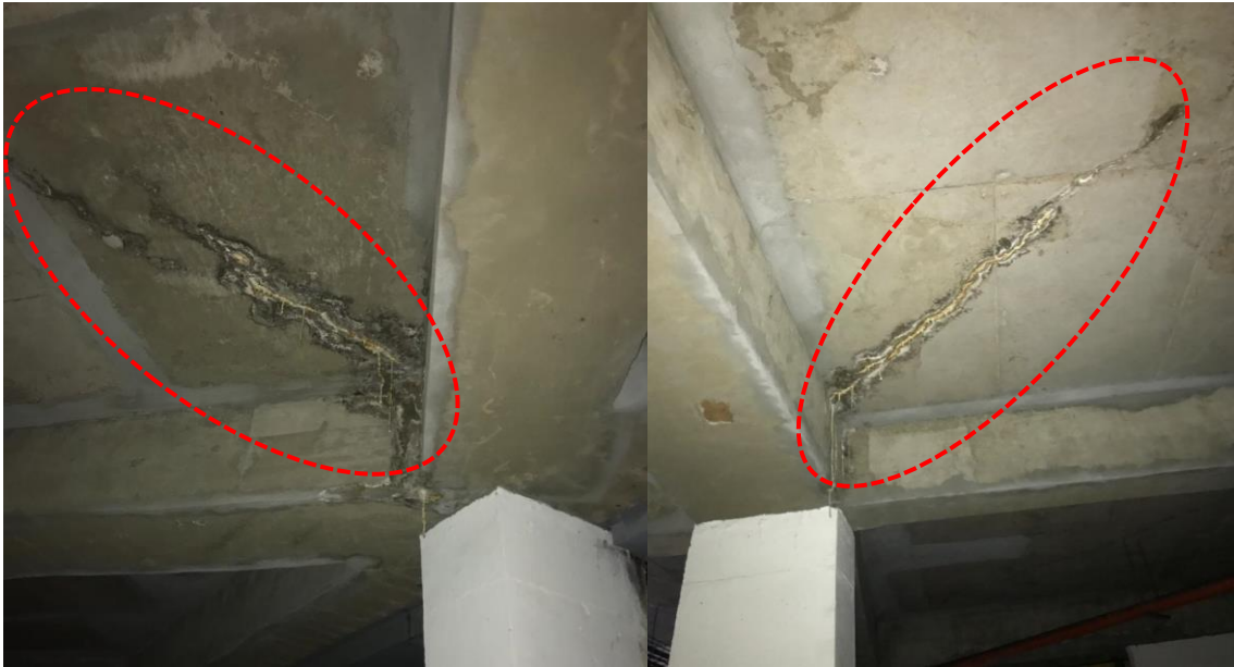
Figura 11. a) Eflorescencias en el concreto por fisuras en plataforma vehicular Conjunto Residencial Puerta Mayor. b) Eflorescencias en el concreto por fisuras en plataforma vehicular en un vértice diferente.
