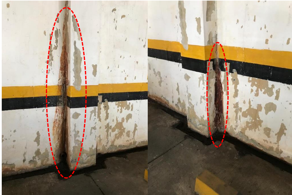
Figura 9. a) Humedad por filtración lateral en muro de contención Conjunto Residencial Mirador del Valle. b) Humedad por filtración lateral en muro de contención vista desde otro ángulo.
