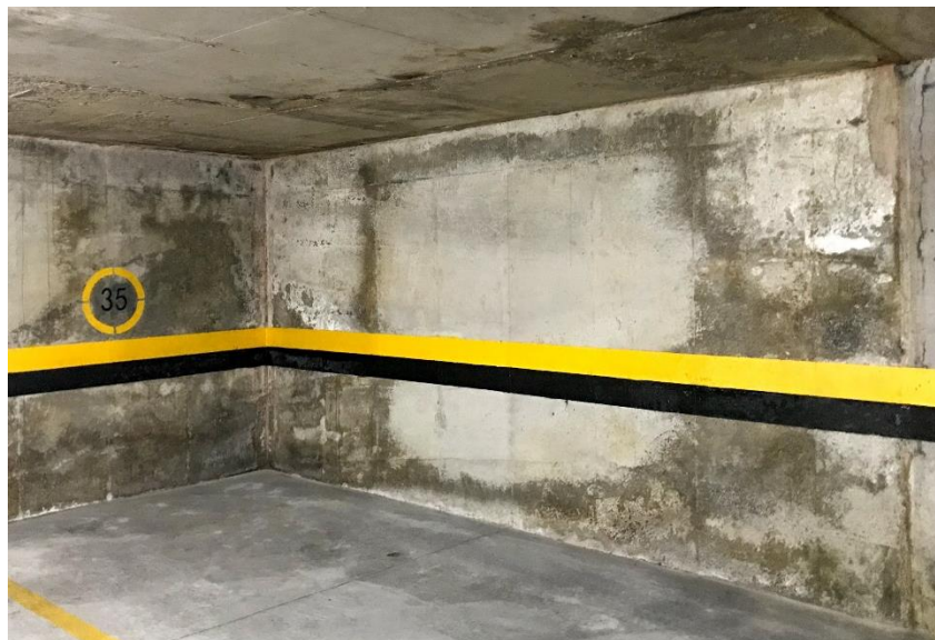
Figura 16. Eflorescencia en una pantalla de concreto.
