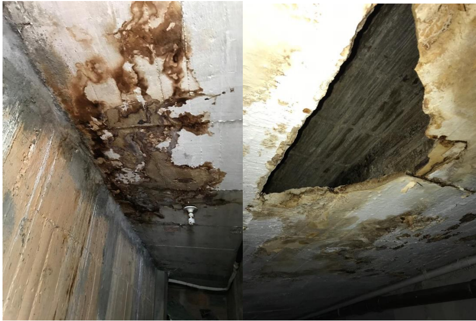
Figura 15. a) Manchas en el concreto por proceso de oxidación y/o carbonatación del acero de refuerzo. b) Desprendimiento del concreto por proceso de corrosión y/o carbonatación del acero de refuerzo en losa aligerada.
