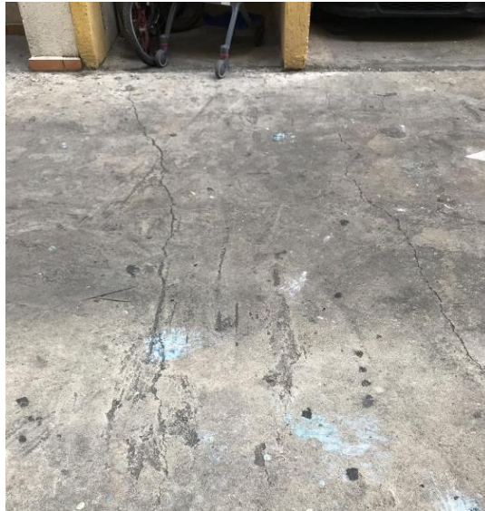
Figura 14. Fisuras causadas por la retracción del concreto en losa de una plataforma vehicular.
