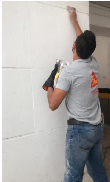
Figura 12. Aplicación de muestra en sitio de estuco acrílico para exteriores (Estuka Acrílico) en Conjunto Residencial Britania.
