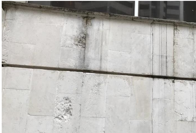
Figura 17. Erosión de la piedra natural como elemento de fachada.
