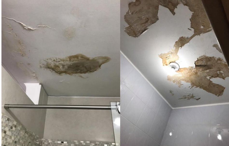
Figura 25. a) Humedad presente en nivel inmediatamente inferior a una terraza. b) humedad presente en la parte inferior de una cubierta con tráfico peatonal.
