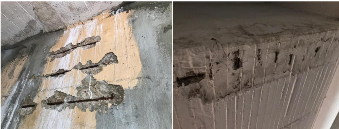
Figura 34. a) Descascaramiento en parte externa del vaso de una piscina por corrosión a causa del cloro presente en el agua que filtra. b) Igualmente ocurre en la fotografía de la derecha.
