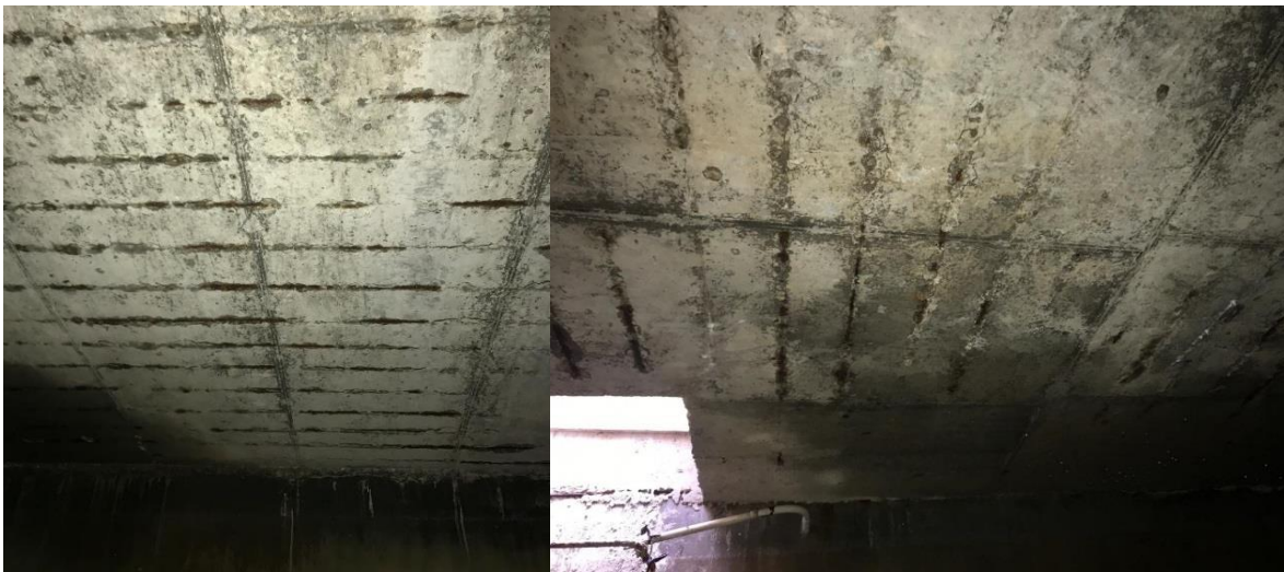
Figura 6. a) Corrosión en el acero de refuerzo de placa superior del tanque de almacenamiento de agua potable Conjunto Residencial Villa Cañaverál. b) Corrosión en el acero de refuerzo de placa superior del tanque de almacenamiento de agua potable visto desde otro ángulo.
