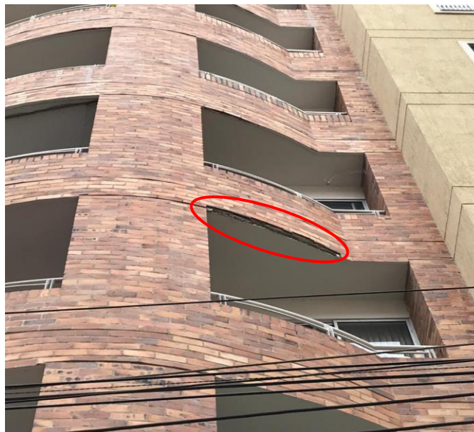
Figura 10. Desprendimiento de piezas en fachada de Edificio Jordán de Sajonia.
