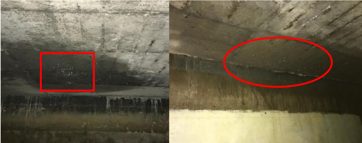
Figura 5. a) Filtraciones presentes en la placa superior de tanque de almacenamiento de agua potable Conjunto Residencial Villa Cañaverál. b) Filtraciones y goteo presentes en la placa superior de tanque de almacenamiento de agua potable visto desde otro ángulo.
