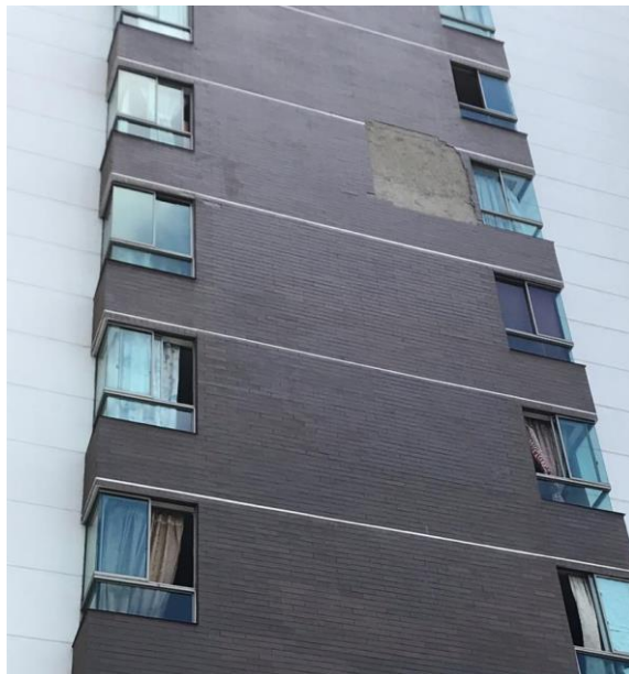
Figura 32. Desprendimiento del acabado de la fachada en una edificación de vivienda.
