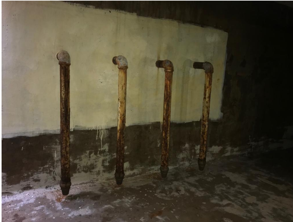
Figura 18. Corrosión en tuberías de acero galvanizado de tanque de almacenamiento de agua potable.
