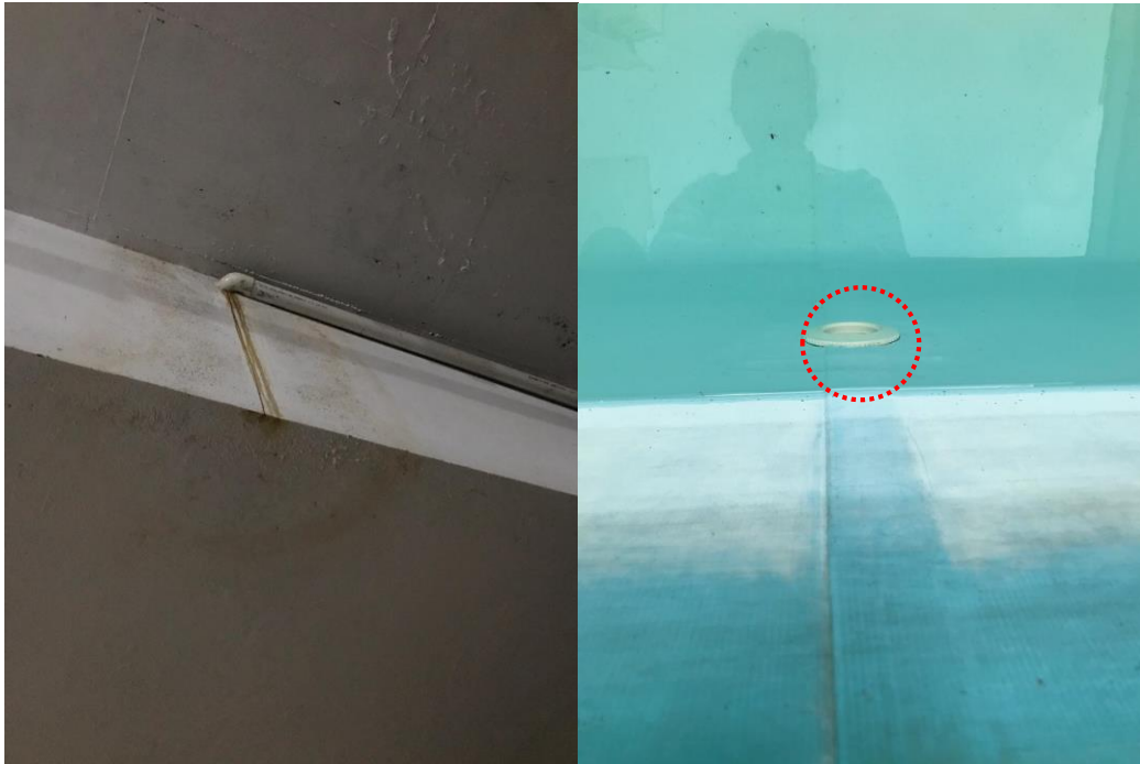
Figura 35. a) Filtración presente en parte externa del vaso de una piscina. b) Accesorio por el cual ocurre la filtración mostrada en la figura de la izquierda.
