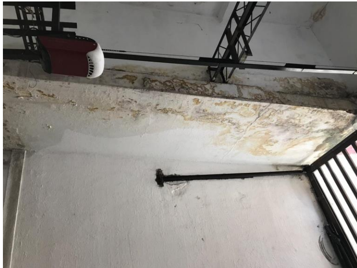
Figura 27. Humedad presente en parte exterior de la estructura de una jardinera.
