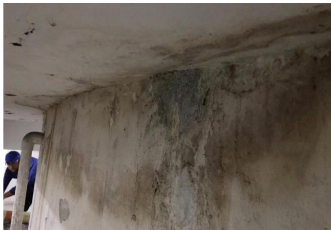
Figura 26. Mancha de humedad en parte externa del vaso de una piscina.
