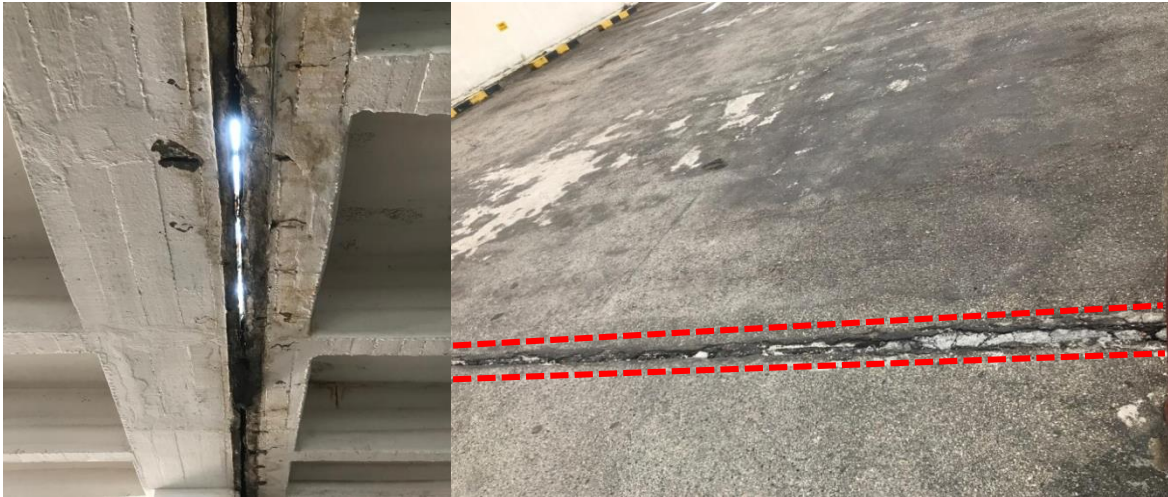
Figura 7. a) Junta de construcción expuesta que permite el paso del agua hacia el interior del parqueadero vista desde la parte inferior de la plataforma vehicular Conjunto Residencial Mirador del Valle. b) Junta de construcción expuesta que permite el paso del agua hacia el interior del parqueadero vista desde la parte superior de la plataforma vehicular.
