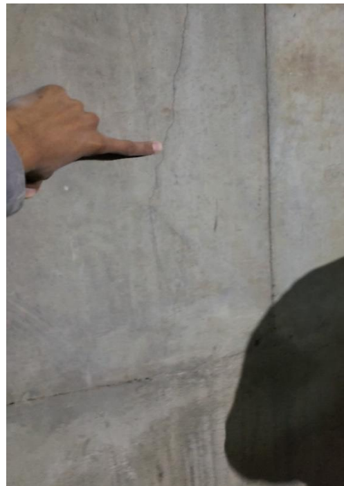
Ilustración 28. Señalamiento de Grietas
