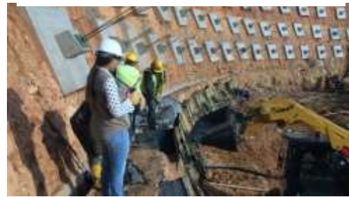
Fotografía 19: revisión fundida de dado de anclaje, fuente propia.
