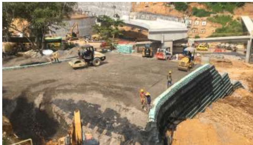
Fotografía 6: Tierra armada intercambiador de Fátima, fuente propia.
