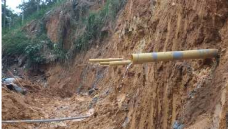
Fotografía 9: Drenes en intercambiador de Fátima, fuente propia.
