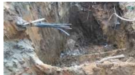
Fotografía 23 inicio de excavación para zarpa y muro 2 anclajes alto viento 2, fuente propia.
