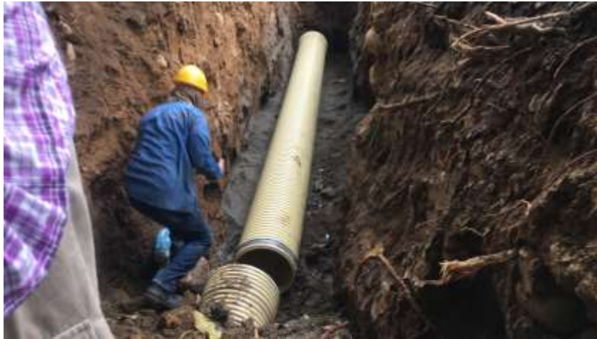
Fotografía 7: Red de acueducto intercambiador Fátima, fuente propia.
