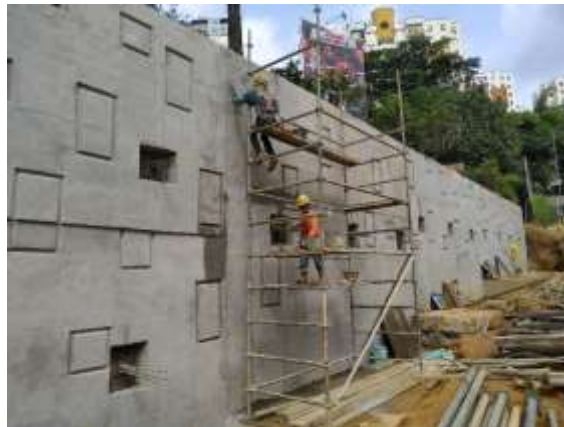
Fotografía 14: muros anclados alto viento, fuente propia.
