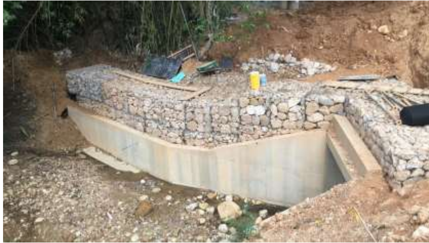
Fotografía 11: Armado de gaviones a lo ancho de la entrada de un box culvert, fuente propia.
