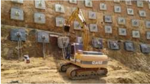
Fotografía 45 caída de anclaje, fuente propia.
