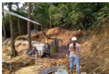
Fotografía 76: revisión fundida de box canal, fuente propia.
