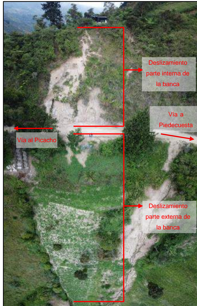
Fotografía 1. Vista general del sitio, mostrando el deslizamiento interno y externo.
