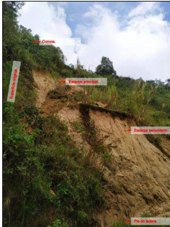
Fotografía 5. Vista lateral del sitio de estudio y definición de partes de un deslizamiento.
