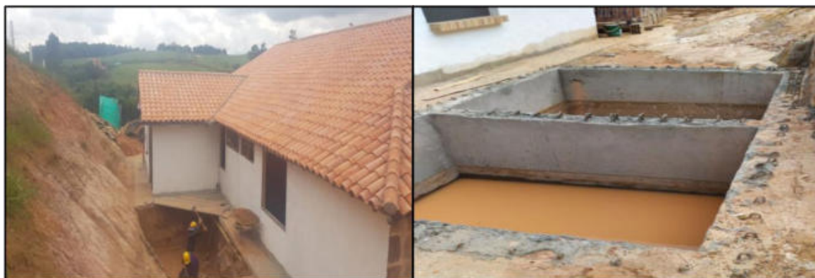
Ilustración 70. Tanque subterráneo casa 221 Fuente: Propia
