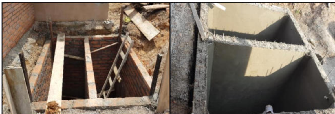
Ilustración 69. Tanque subterráneo casa 294 Fuente: Propia
