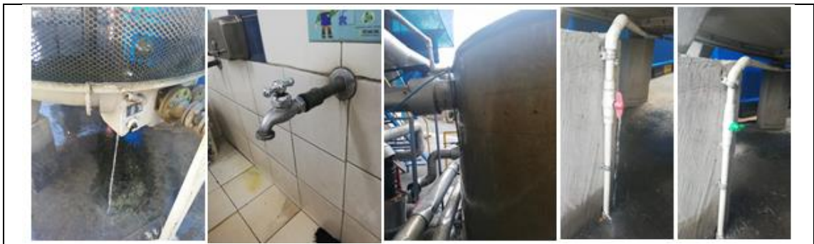
Figura 4. Evidencia de fugas y cambio de llaves.
