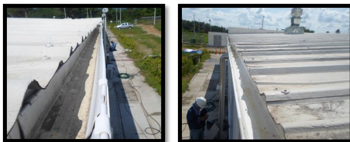
Figura 14 Canaletas para recolección de agua lluvia Fuente: El autor
