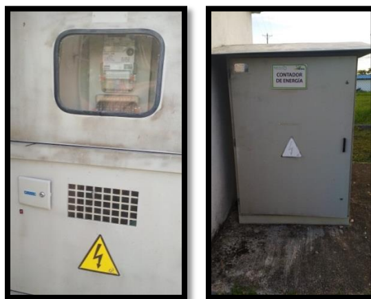
Figura 21 Contador de energía ESSA. Fuente: El autor
