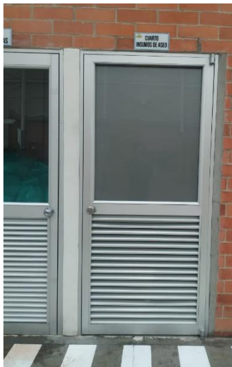
Imagen 2. Almacenamiento sustancias químicas Oficinas varios administrativo
