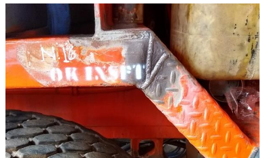
Fisura corregida por soldador Fisura chasis – parte delantera derecha
