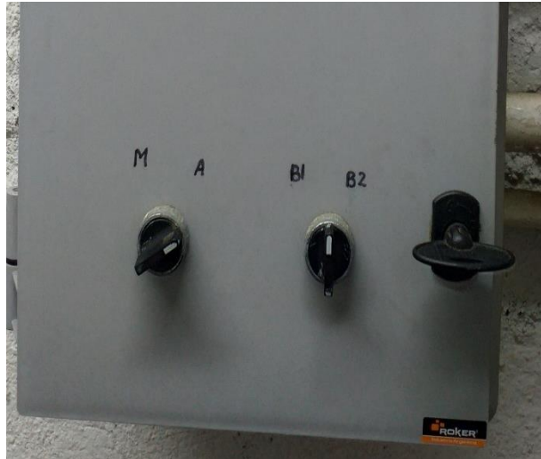
Ilustración 46. Tablero de control bombas de agua de respaldo CLÍNICA FOSCAL.
