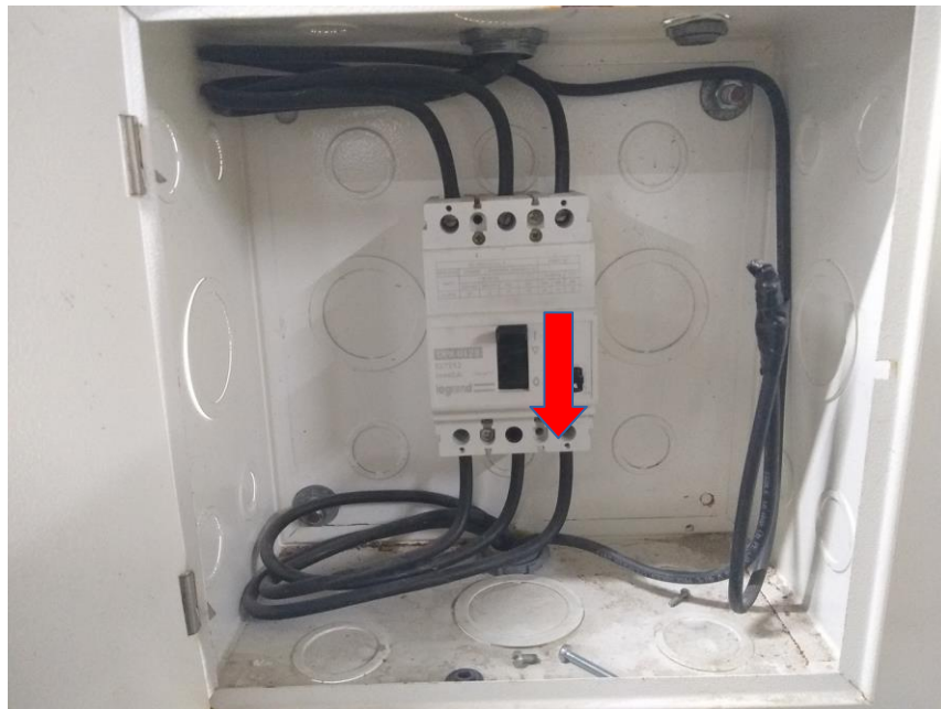
Ilustración 16 Totalizador de energía de la caldera CLÍNICA FOSCAL INTERNACIONAL
