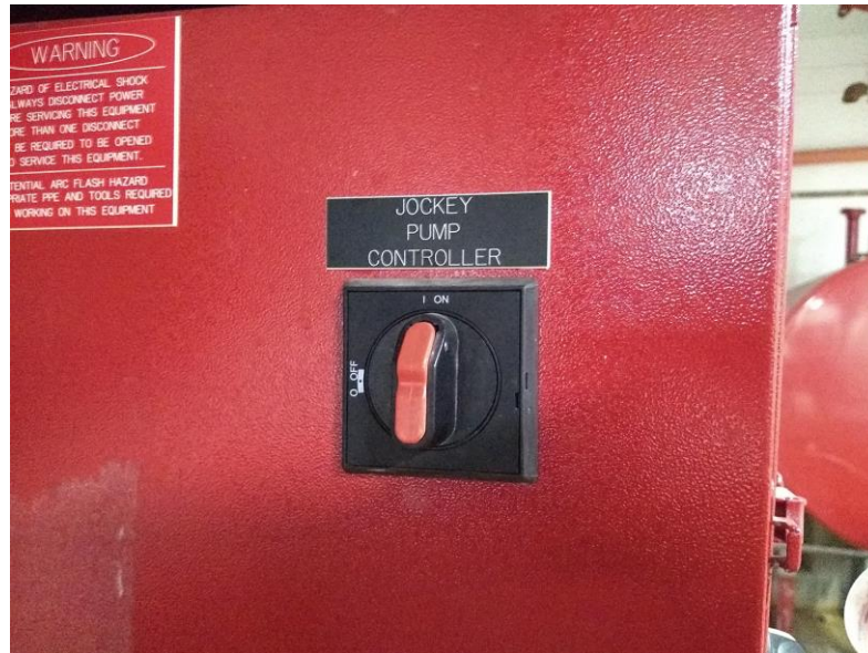
Ilustración 39. Energizador de la Bomba JOCKEY contraincendios CLÍNICA FOSCAL INTERNACIONAL
