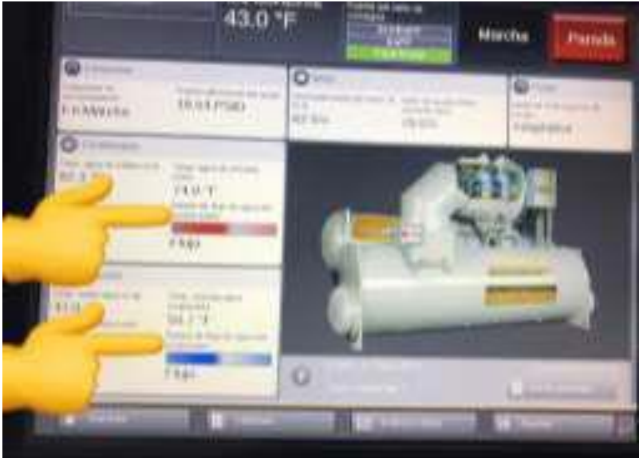
Ilustración 36. Interfaz de estado de funcionamiento del CHILLER CLÍNICA FOSCAL INTERNACIONAL
