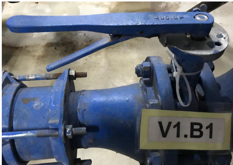
Ilustración 7. Válvulas de paso de agua impulsada por la bomba de agua potable CLÍNICA FOSCAL INTERNACIONAL
