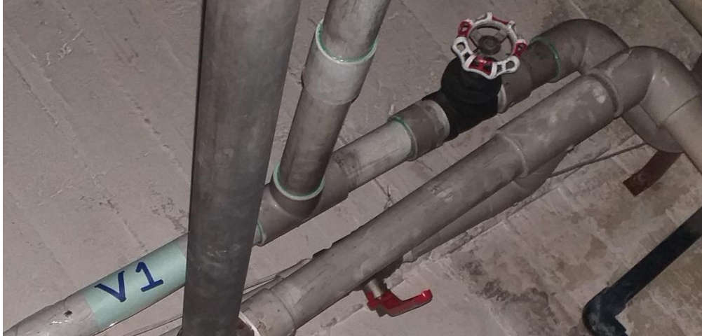
Ilustración 47. Válvula 1 de suministro de agua a bombas CLÍNICA FOSCAL.
