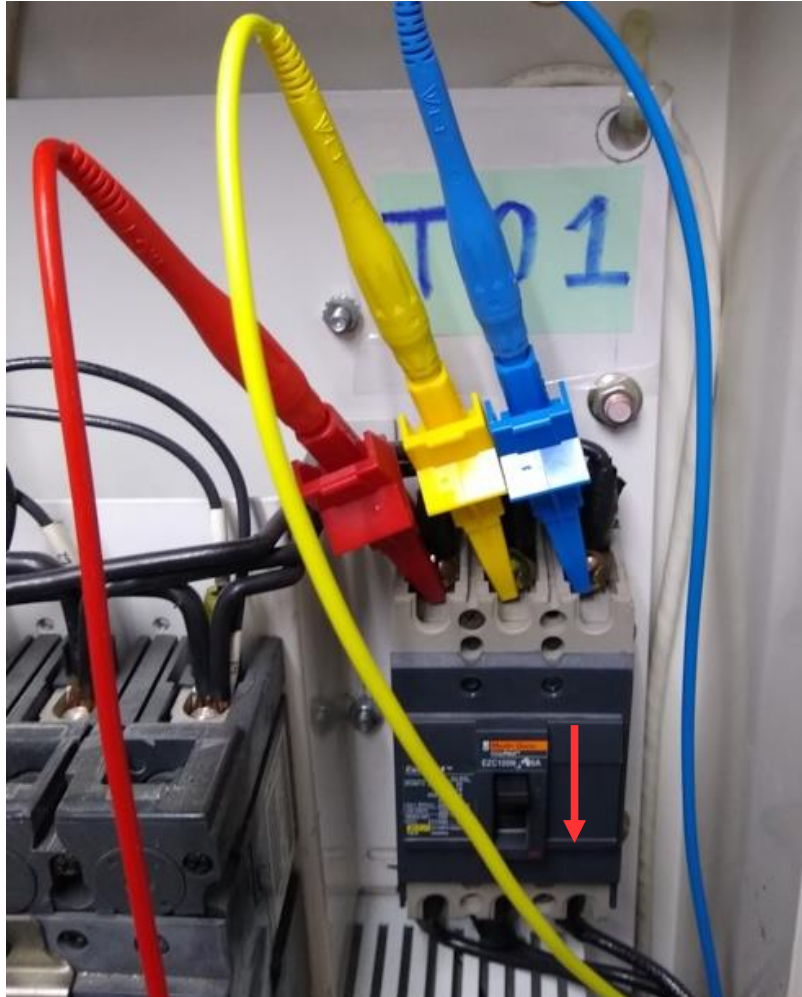
Ilustración 62. Totalizador principal CHILLER RESONANCIA MAGNÉTICA
