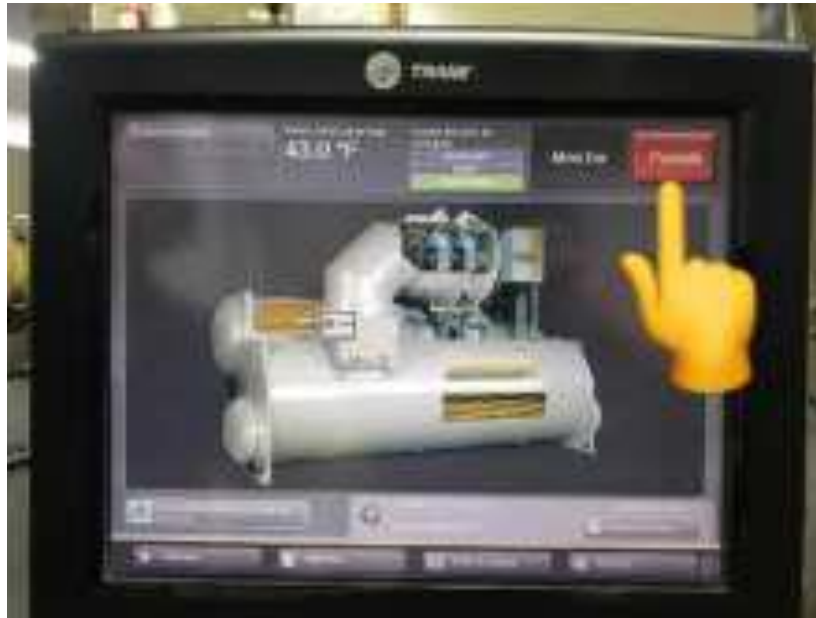
Ilustración 35. Interfaz de estado de funcionamiento del CHILLER CLÍNICA FOSCAL INTERNACIONAL
