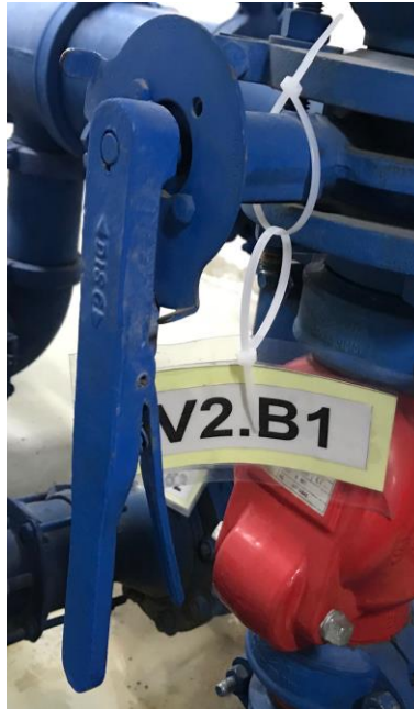
Ilustración 6. Válvulas de paso de agua impulsada por la bomba de agua potable CLÍNICA FOSCAL INTERNACIONAL
