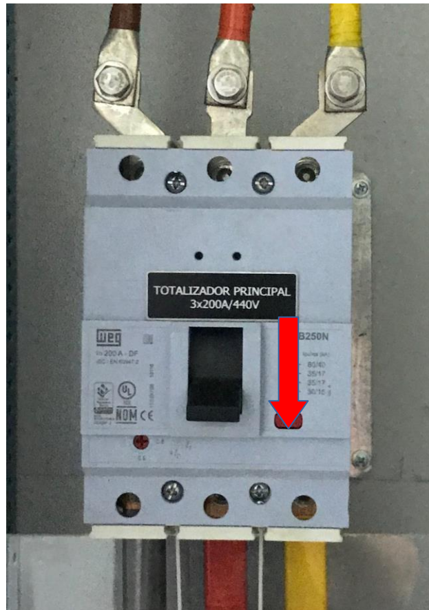
Ilustración 29. Totalizador de energía del CHILLER CLÍNICA FOSCAL INTERNACIONAL
