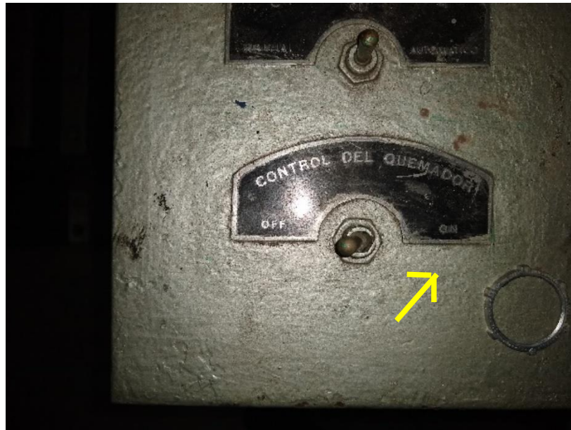
Ilustración 55. Selector del sistema de llama caldera 80BHP CLÍNICA FOSCAL
