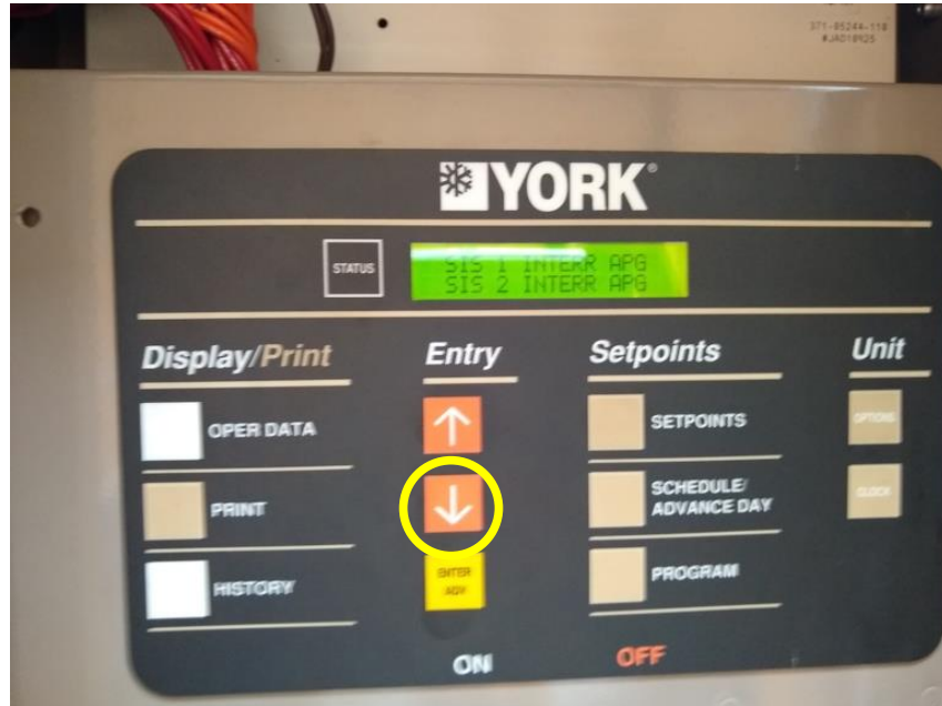
Ilustración 74. Display CHILLER RESPALDO TMS
