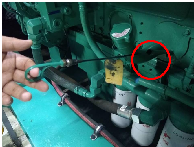
Ilustración 23. Nivel de aceite del motor de la planta eléctrica CLÍNICA FOSCAL INTERNACIONAL
