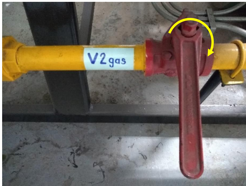
Ilustración 54. Válvula principal de suministro de gas caldera 80BHP CLÍNICA FOSCAL.
