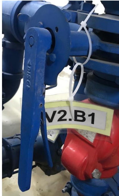
Ilustración 9 Válvulas de paso de agua impulsada por la bomba de agua potable CLÍNICA FOSCAL INTERNACIONAL
