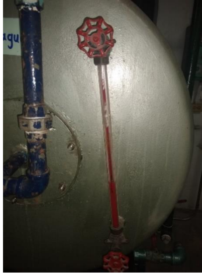
Ilustración 53. Nivel del agua del tanque de condensado caldera 80BHP CLÍNICA FOSCAL.
