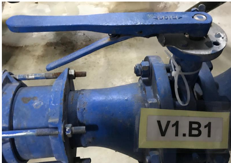
Ilustración 10. Válvulas de paso de agua impulsada por la bomba de agua potable CLÍNICA FOSCAL INTERNACIONAL
