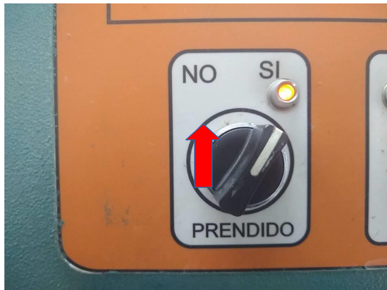
Ilustración 13. Selector de ignición de la caldera CLÍNICA FOSCAL INTERNACIONAL
