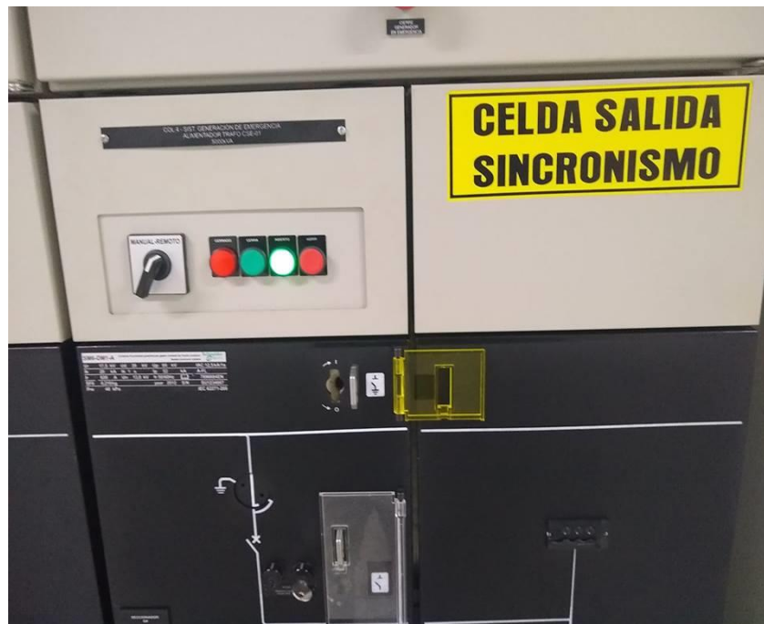
Ilustración 25. Celdas de sincronismo de la planta eléctrica CLÍNICA FOSCAL INTERNACIONAL
