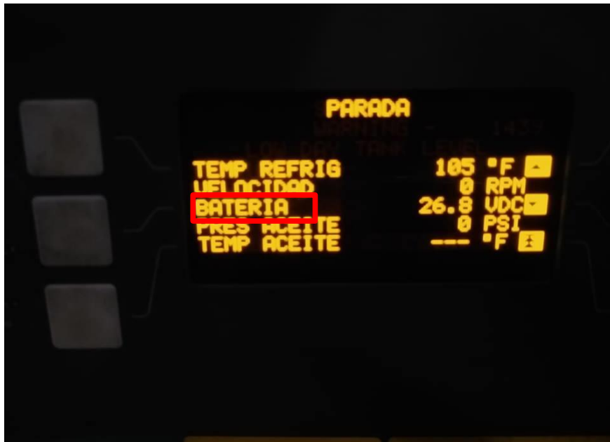
Ilustración 21. Parámetros de funcionamiento planta eléctrica CLÍNICA FOSCAL INTERNACIONAL
