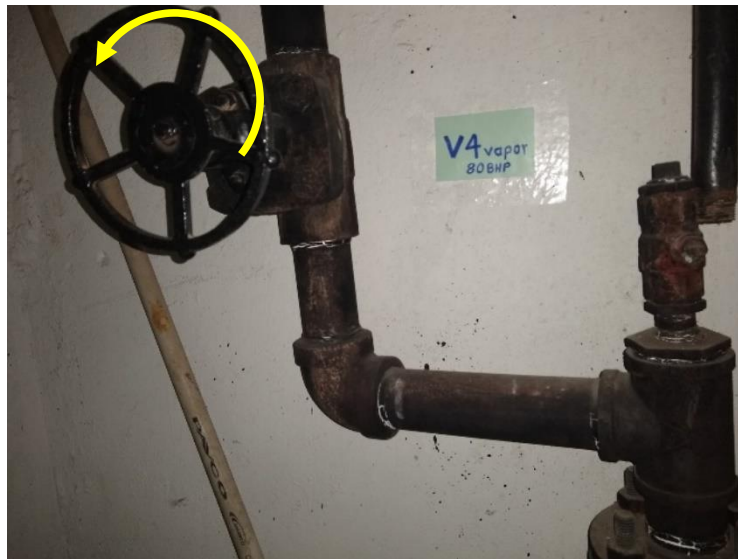
Ilustración 57. Válvulas de suministro de vapor de agua al complejo médico CLÍNICA FOSCAL
