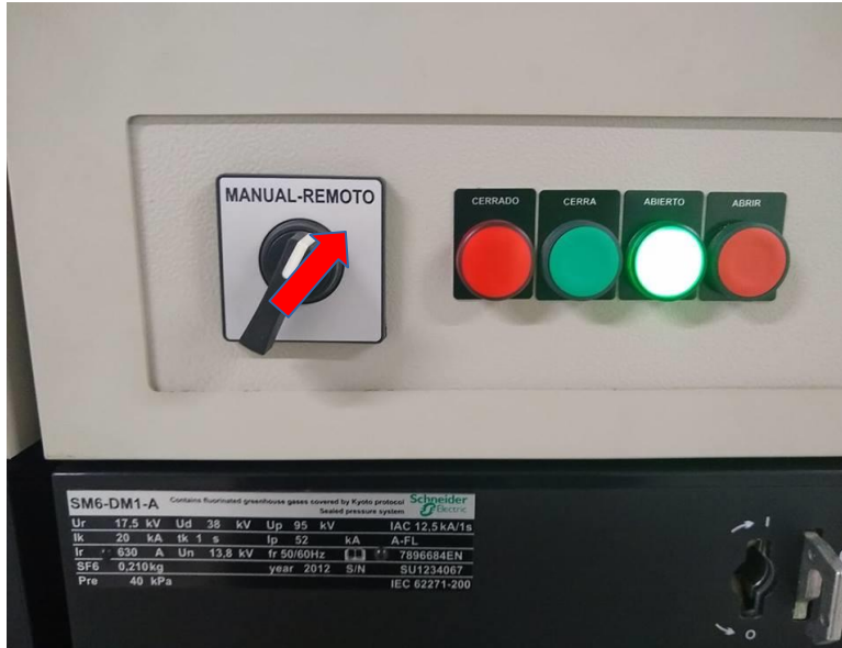
Ilustración 26. Celdas de sincronía de la planta eléctrica CLÍNICA FOSCAL INTERNACIONAL
