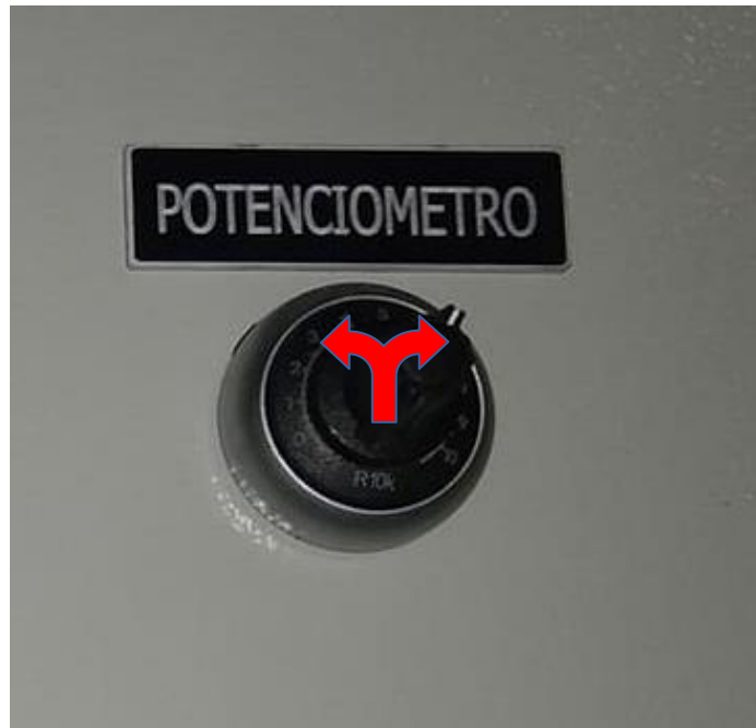
Ilustración 34. Tablero de control (perilla de potenciómetro) CHILLER CLÍNICA FOSCAL INTERNACIONAL
