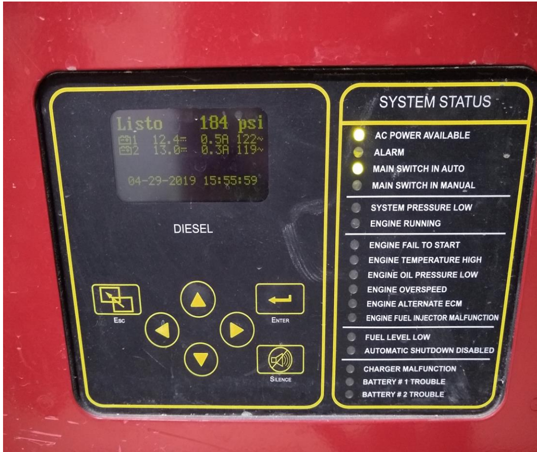
Ilustración 44. Tablero de estado (display) Bomba principal contraincendios CLÍNICA FOSCAL INTERNACIONAL
