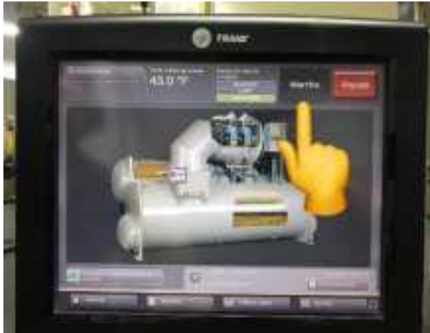
Ilustración 37. Interfaz de estado de funcionamiento del CHILLER CLÍNICA FOSCAL INTERNACIONAL
