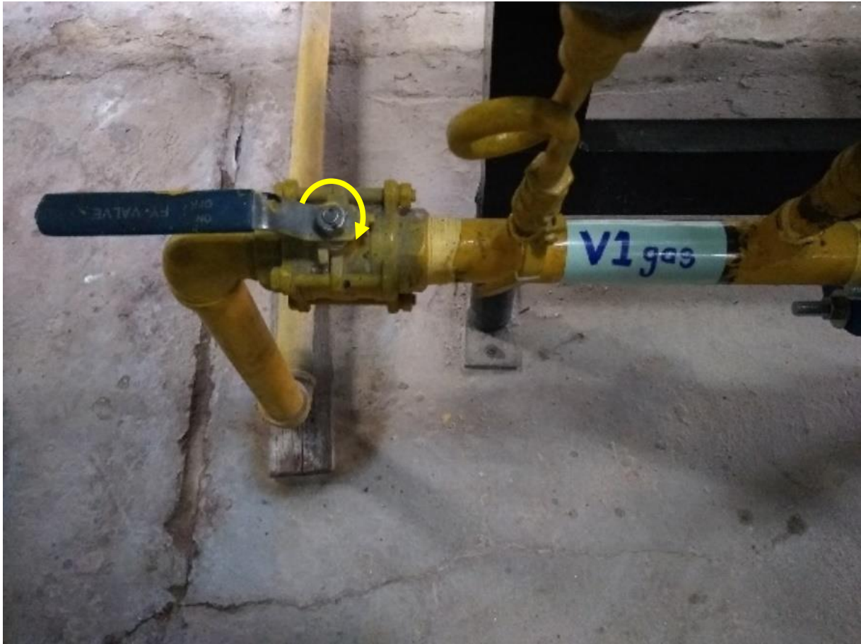
Ilustración 52. Válvula principal de gas caldera 50BHP CLÍNICA FOSCAL.
