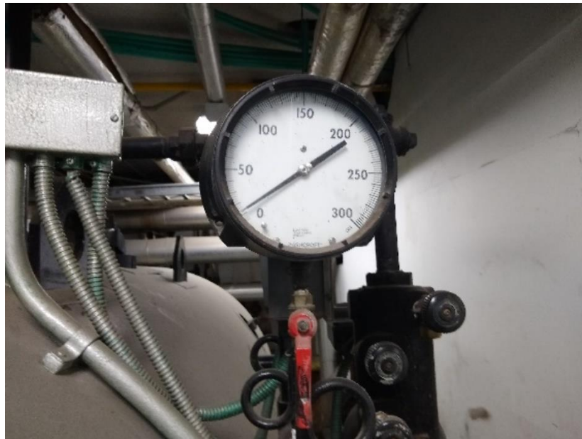
Ilustración 56. Manómetro de presión de vapor caldera 80BHP CLÍNICA FOSCAL.
