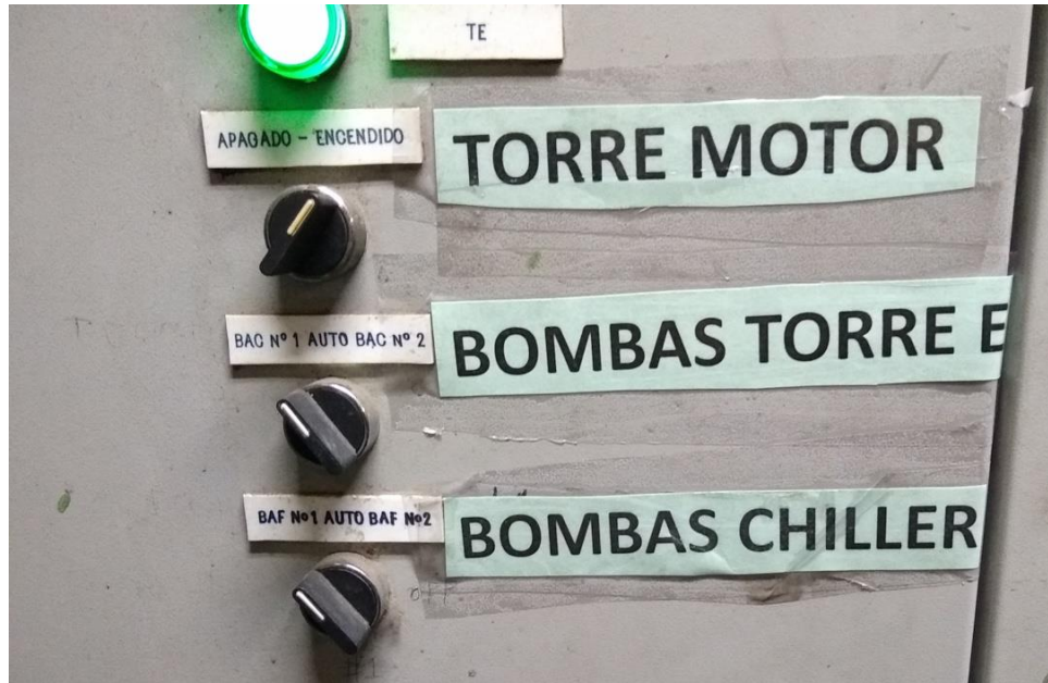
Ilustración 69. Tablero de control CHILLER TMS
