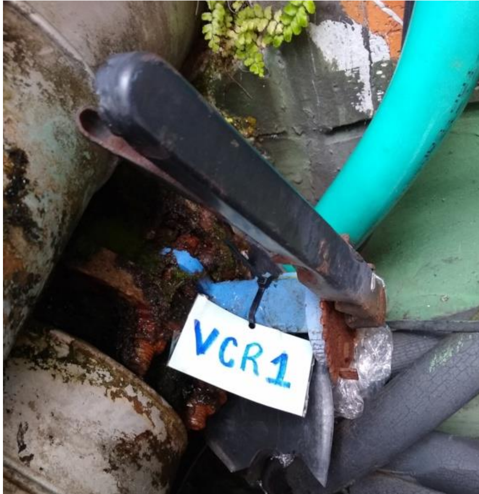
Ilustración 70. Válvula principal de suministro de agua fría CHILLER RESPALDO TMS
