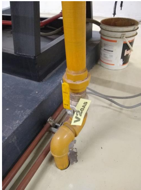
Ilustración 18 Válvula de suministro de gas CLÍNICA FOSCAL INTERNACIONAL
