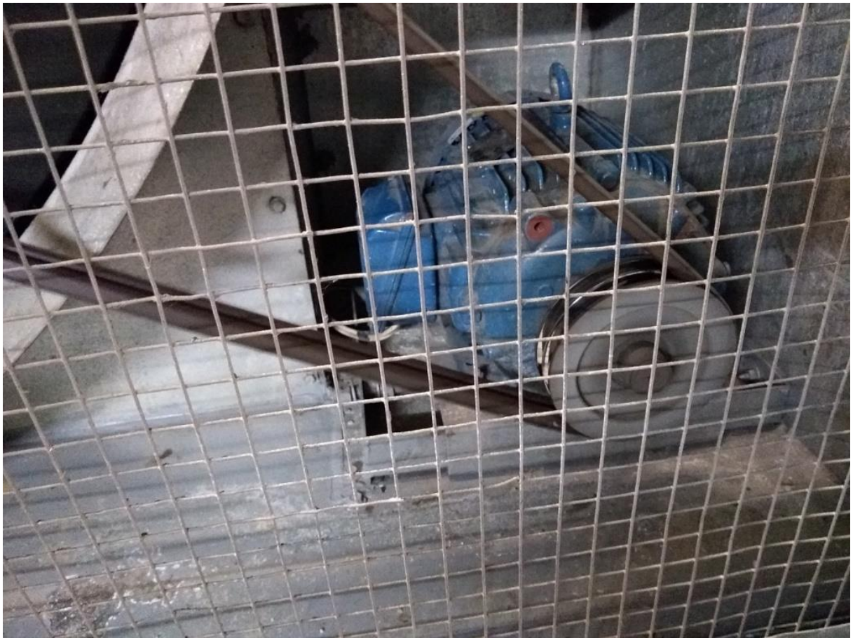
Ilustración 68. Motor de torre de enfriamiento CHILLER TMS
