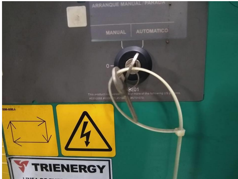
Ilustración 20. Selector de arranque de la planta eléctrica CLÍNICA FOSCAL INTERNACIONAL
