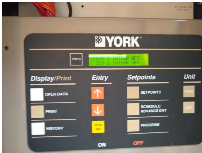
Ilustración 73. Display CHILLER RESPALDO TMS
