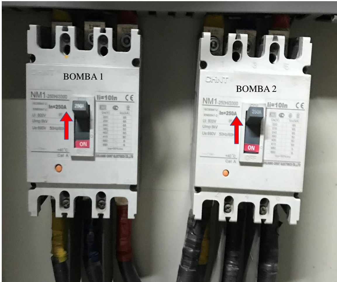
Ilustración 5. Totalizadores de energía de las bombas CLÍNICA FOSCAL INTERNACIONAL
