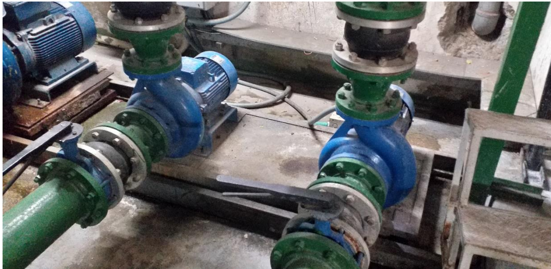
Ilustración 66. Bombas principales de agua fría CHILLER TMS
