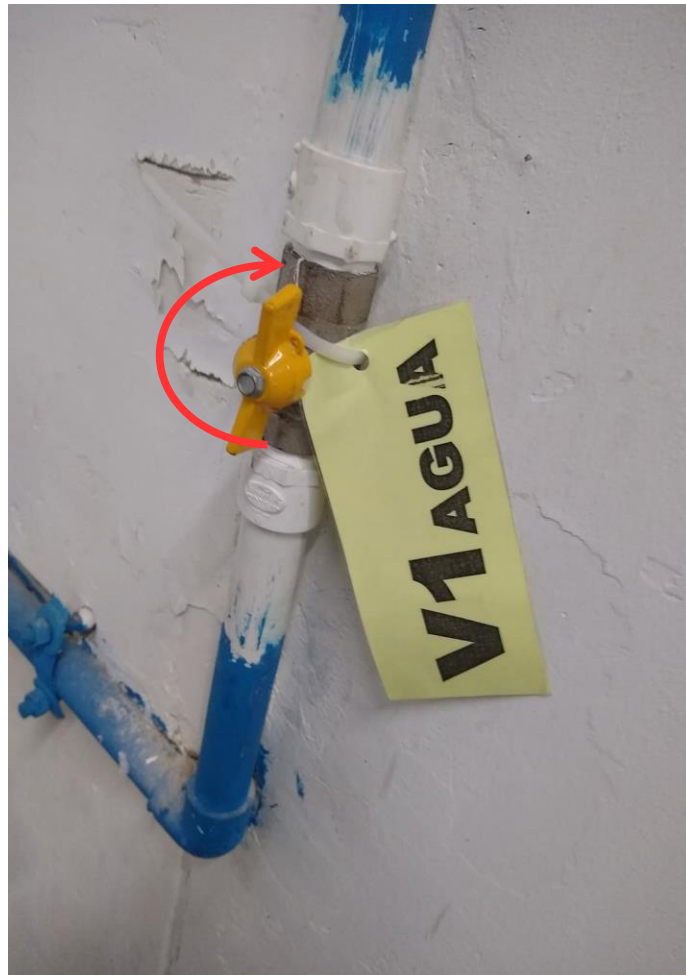
Ilustración 14 Válvula de suministro de agua tanque de condensado CLÍNICA FOSCAL INTERNACIONAL
