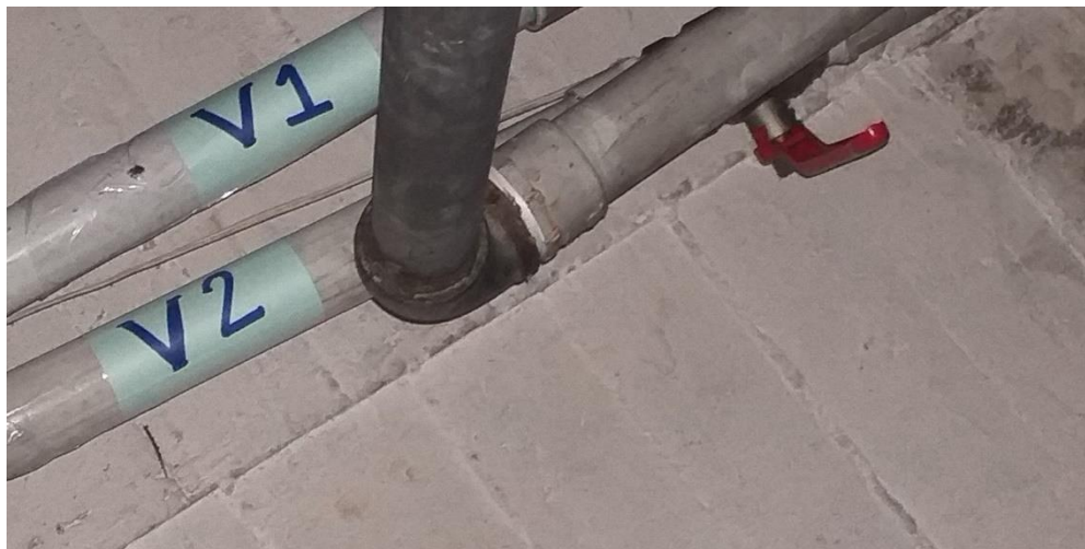
Ilustración 48. Válvula 2 de suministro de agua a bombas CLÍNICA FOSCAL.
