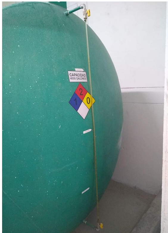
Ilustración 27. Tanque de combustible ACPM para motor de la planta eléctrica CLÍNICA FOSCAL INTERNACIONAL
