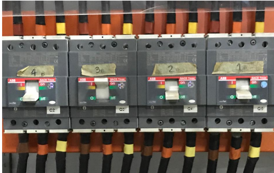
Ilustración 30. Totalizadores de energía de las bombas de agua fría CLÍNICA FOSCAL INTERNACIONAL
