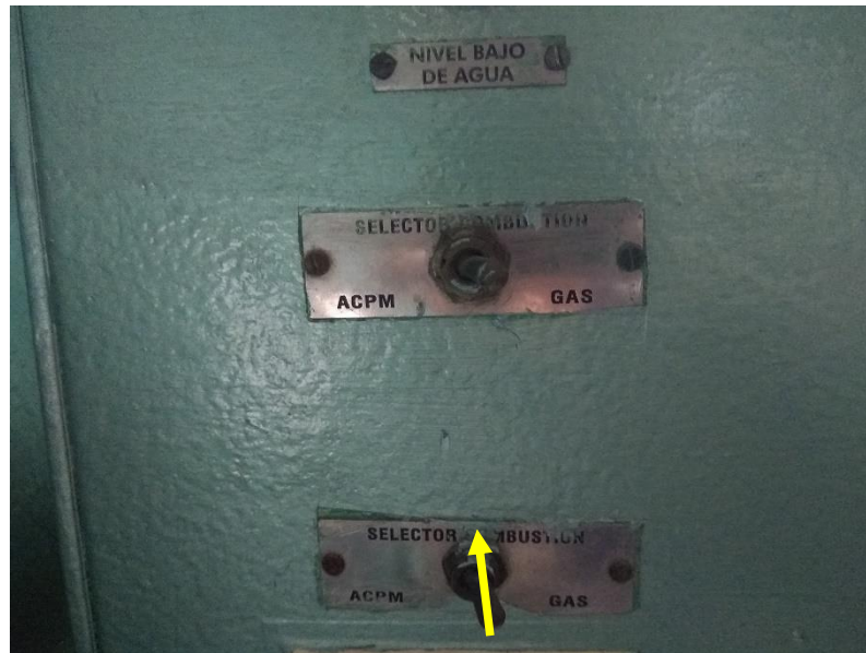
Ilustración 49. Selector de encendido de llama de la caldera 50BHP CLÍNICA FOSCAL.
