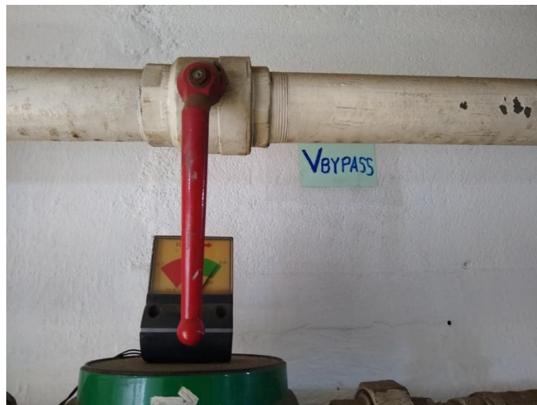
Ilustración 80. Válvula de bypass línea de vacío CLINICA FOSCAL
