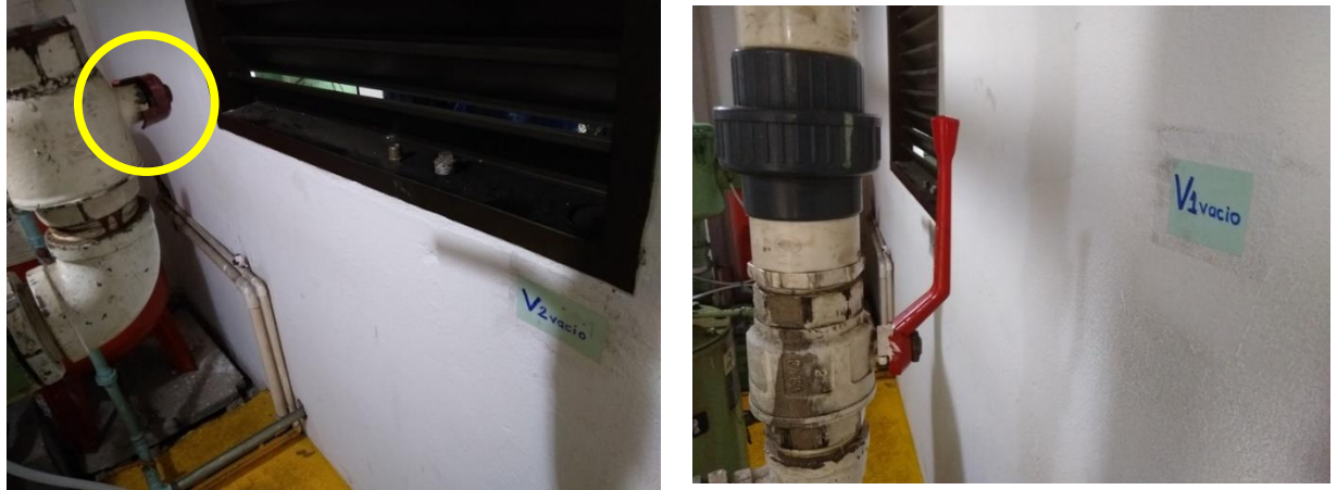
Ilustración 78. Válvulas de succión bombas de vacío CLINICA FOSCAL
