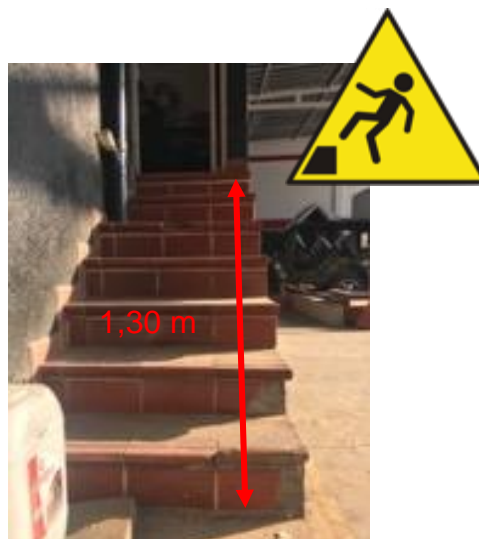
Figura 17. Las escaleras que se dirigen hacia la torre de vigilancia cerca al acceso principal de vehículos se encuentran a una altura de 1,30 m y no cuenta con baranda en ninguno de los dos extremos.
