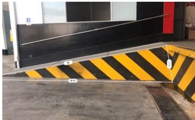
Figura 15. La rampa de acceso a la plataforma tiene su punto más alto a una longitud de 1.1 m, está actualmente cuenta con una baranda en un solo lado (el lado de la pared) y el otro costado se encuentra sin barrera preventiva.
