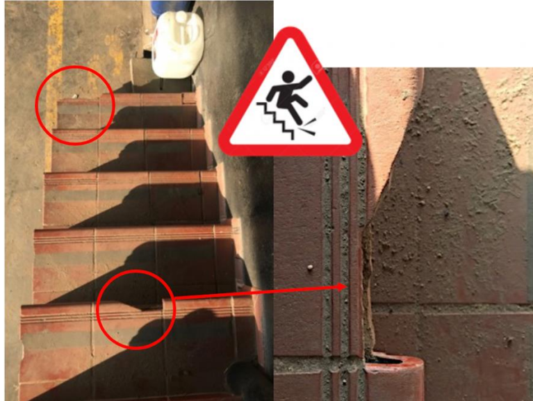
Figura 18. Varios escalones del acceso se encuentran deteriorados o irregulares, representando un peligro potencial que podría generar la desestabilización o tropiezo de cualquier trabajador que las use.
