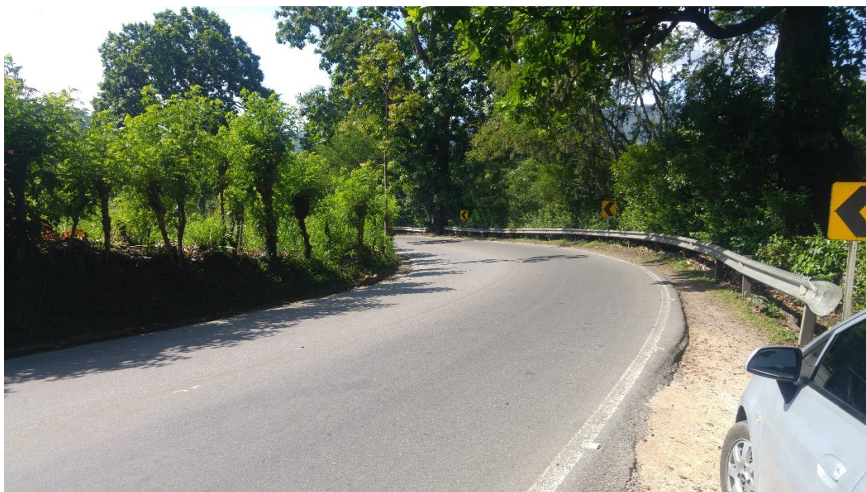
Ilustración 19. Estado de la vía Piedecuesta – Curos (punto El Paramito)
