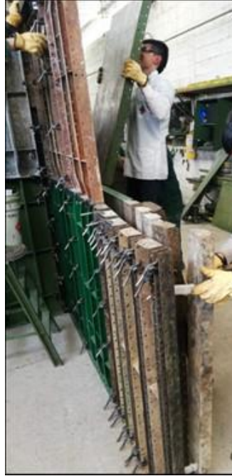
Figura 4. Inducción de Armado, Tableros
