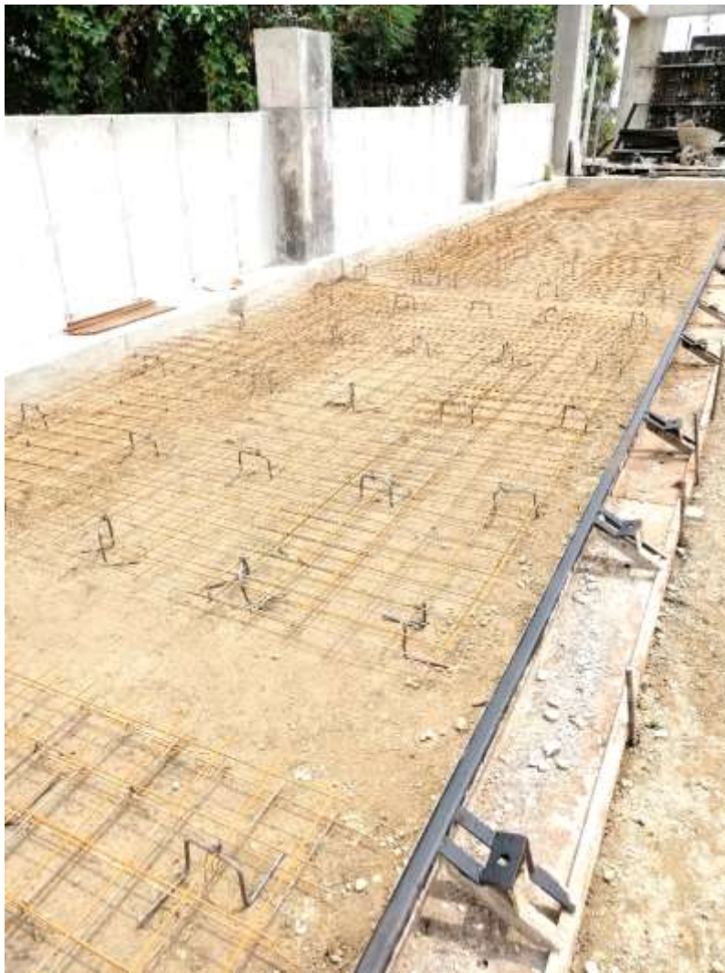
Fig 40. Instalación de refuerzo zona de rampa de descargue de tolvas. Fuente. Propia
