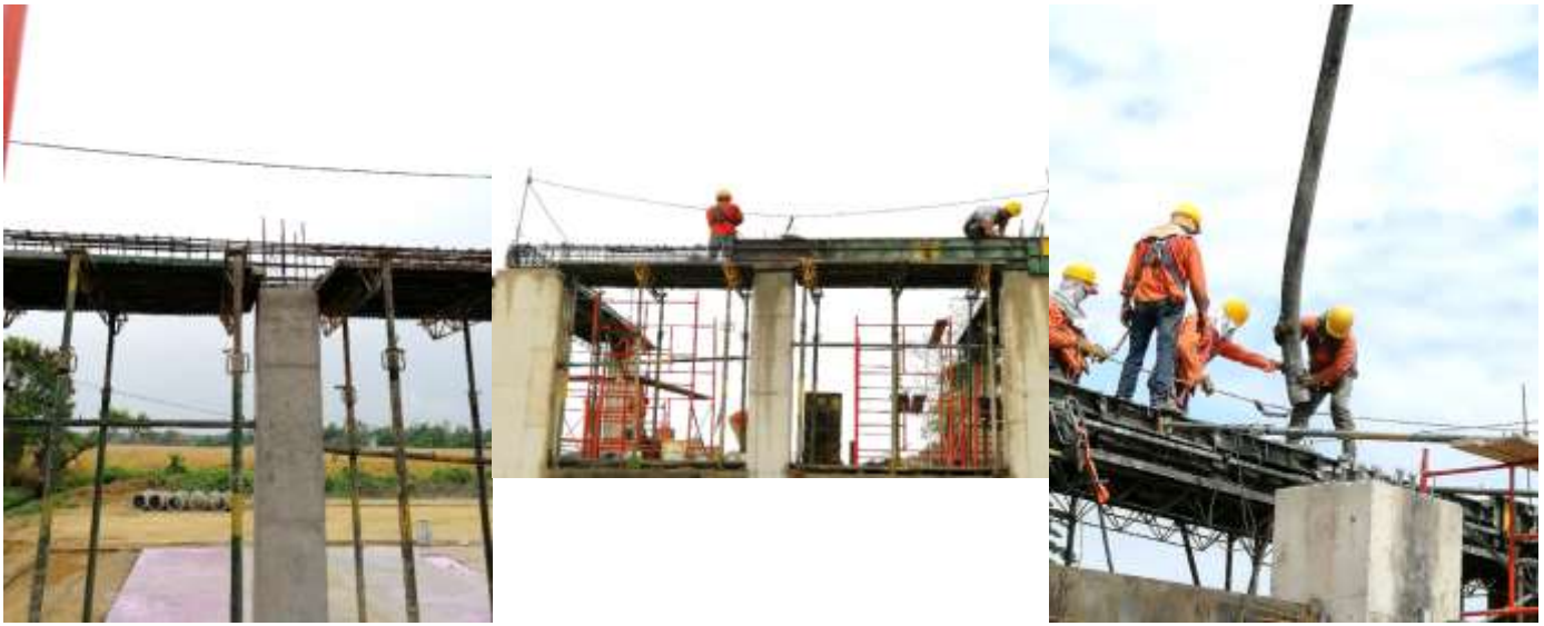
Fig 34. a. Armado de acero de refuerzo. Fuente. Propia b. Instalación de formaletas. Fuente. Propia. c. Vaciado de concreto. Fuente. Propia.
