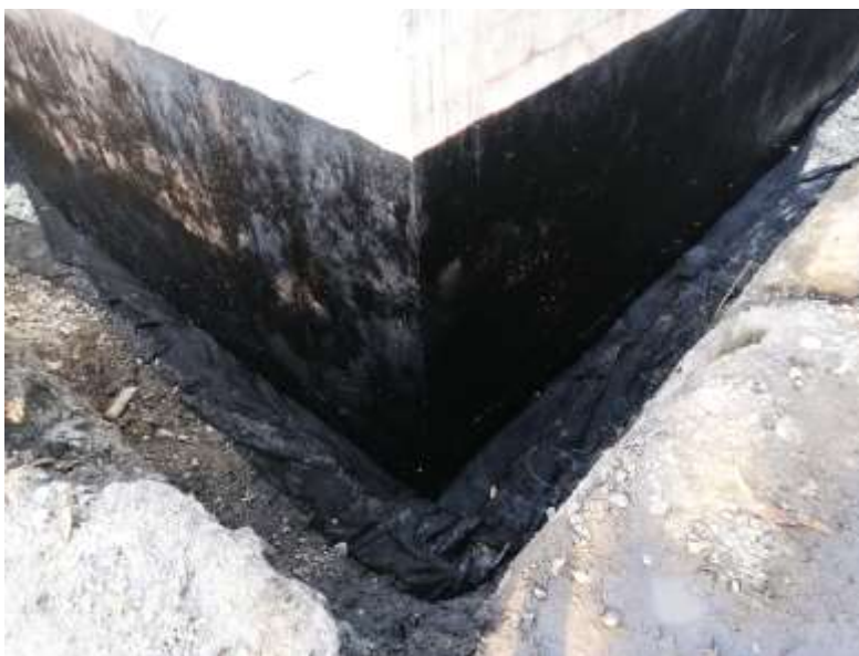
Fig 48. Filtro francés perimetral zona tanque de almacenamiento, Fuente: propia
