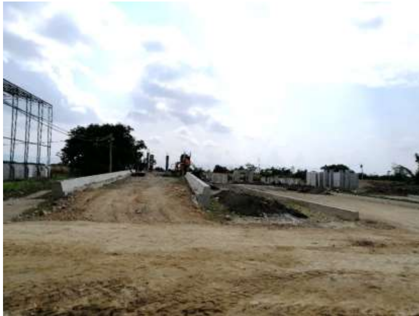
Fig 6. Condiciones iniciales rampa de descargue de tolvas. Fuente. propia
