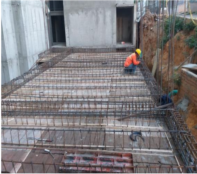
Fotografía 16 Verificación acero de refuerzo de placa de entrespiso Portería del proyecto Reserva del Rosario.
