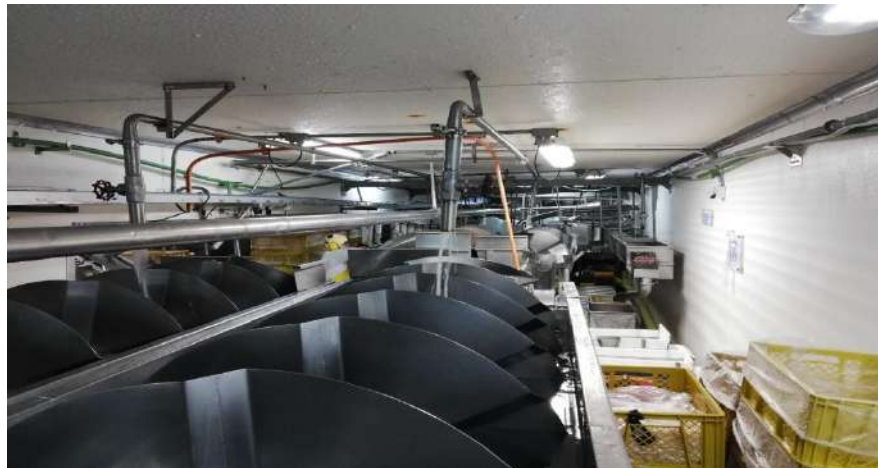
Imagen 7: Área de Chillers.
