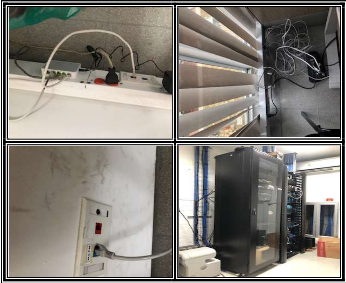
Figura 7. Registro Fotográfico infraestructura de red parte física Fuente: Elaboración Propia (2020)
